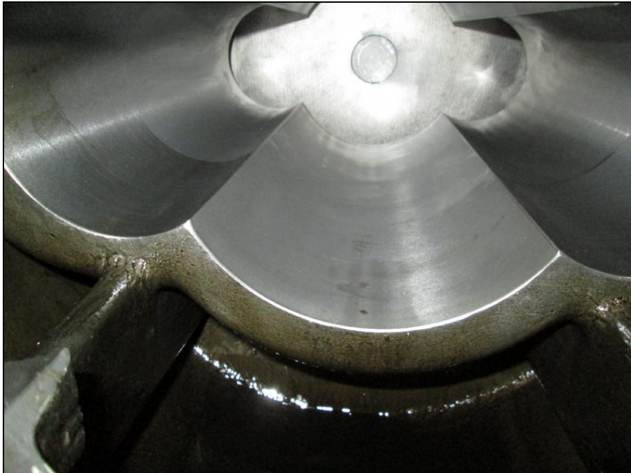
Abbildung 32: Pumpengehäuse nach Ausbau der Spindeln
