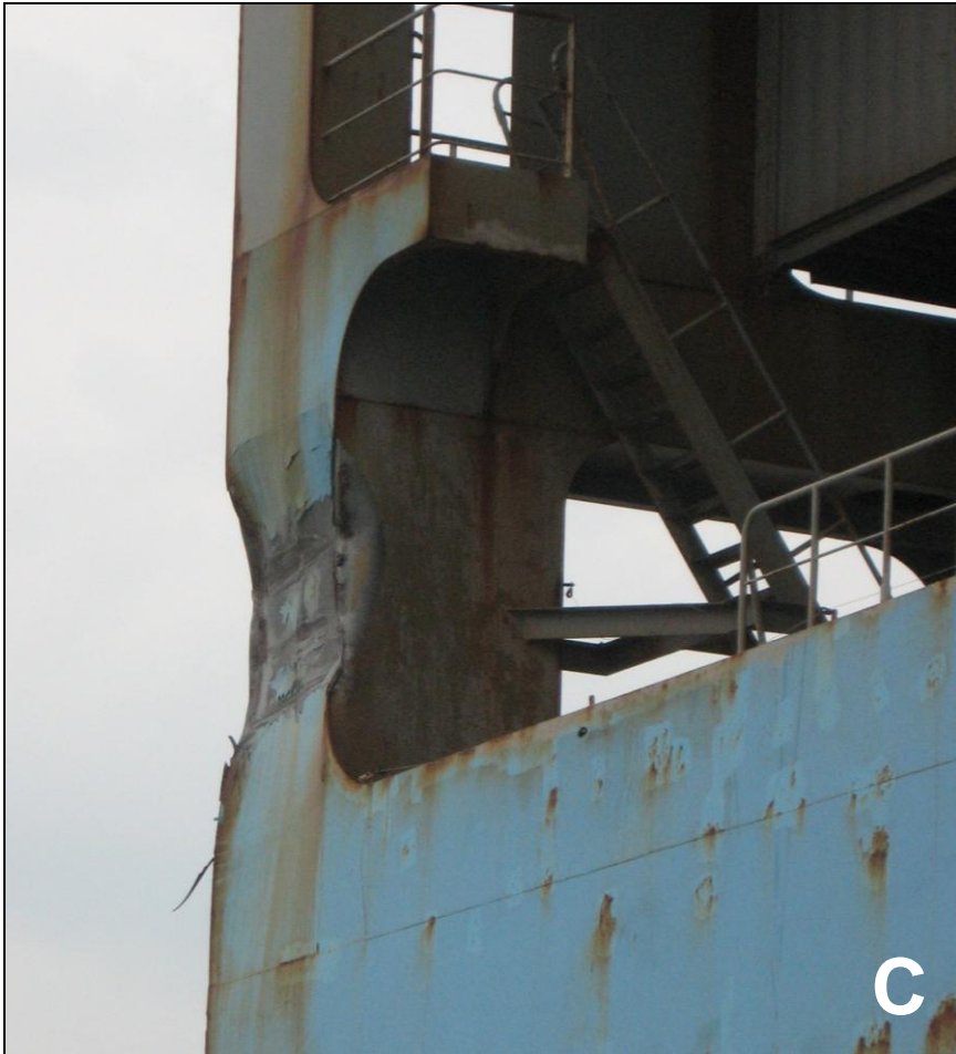
Abbildung 21: Beschädigung Cellguide-Fundament Steuerbordseite Achterkante (Detailaufnahme)
