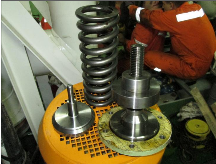
Abbildung 34: Sicherheitsventil der Pumpe nach Demontage
