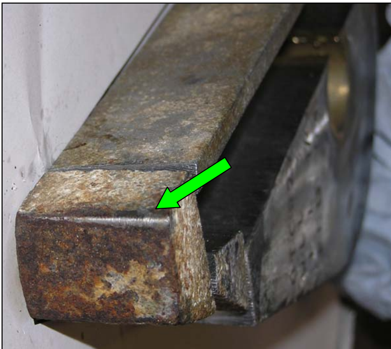
Abb. 20: Vorderer Haken: Rundung von 1,75-2,25 mm. Zur Charakteristik der Rundung ist anzumerken, dass sie asymmetrisch ist und Verschleißkanten vorhanden sind. Die Unterkante des Hakens ist stark korrodiert.
