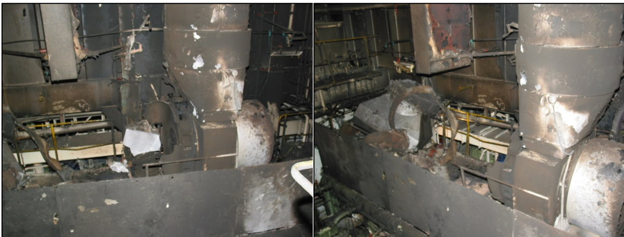
Der Maschinenraum nach dem Brand, die Zerstörungen am Turbolader sind deutlich zu erkennen, Quelle BSU
