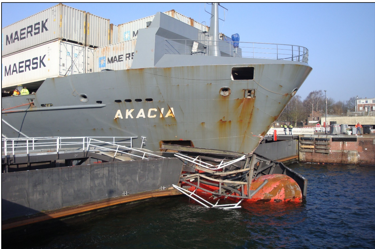
Der Bug des Schiffes hat das Schleusentor durchstoßen und aufgesetzt, Quelle BSU
