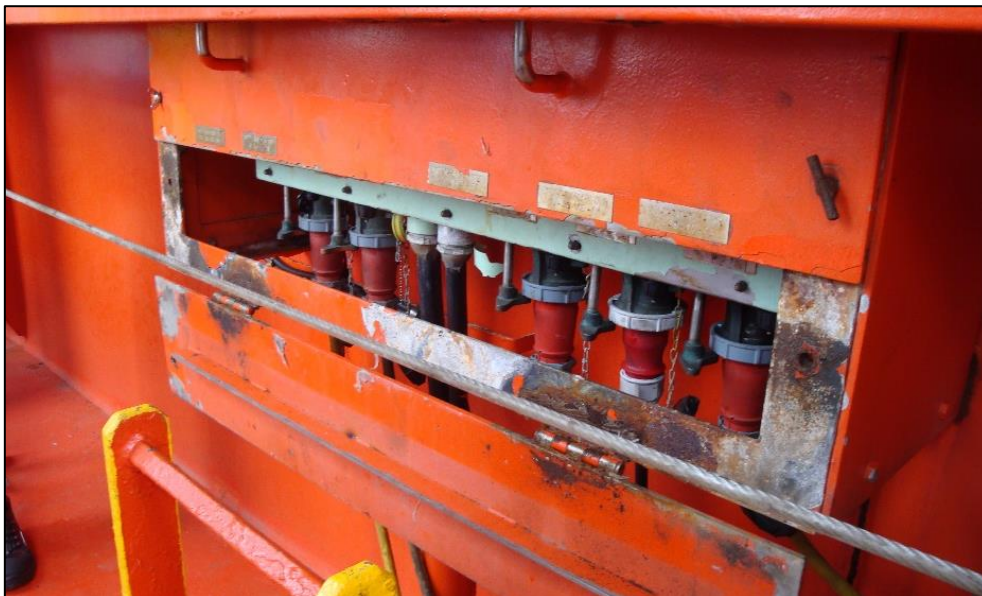
Abbildung 1: Anschluss-/Schaltkasten (untere Zugangsklappe geöffnet)
