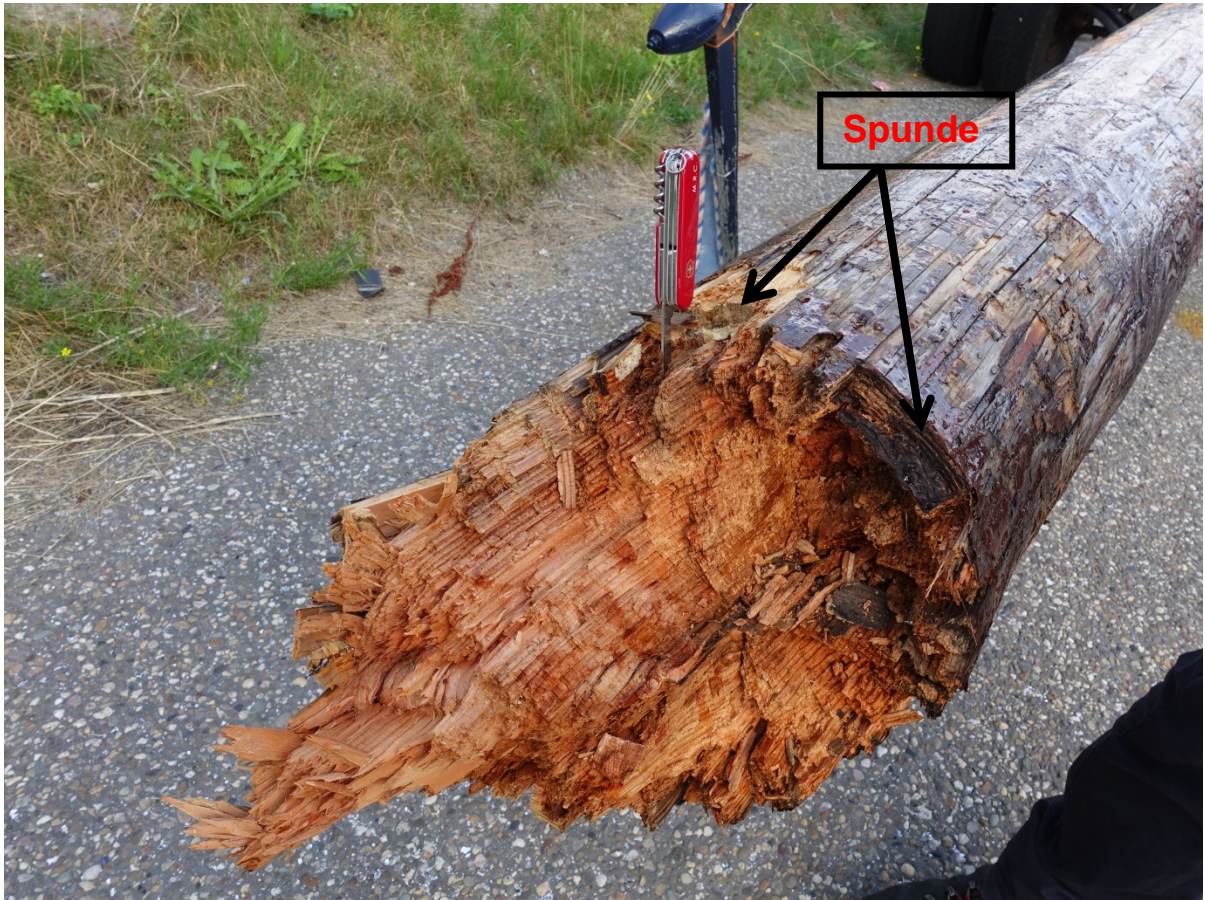
Bruchstelle am stehengebliebenen Teil des Mastes
