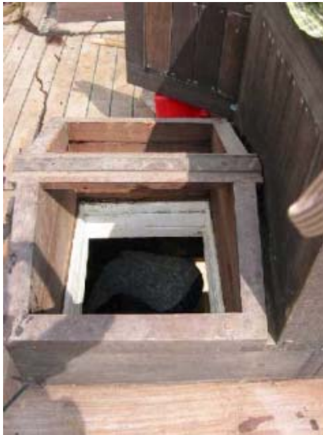
Abbildung 20, Offenes Skylight nach der Bergung
