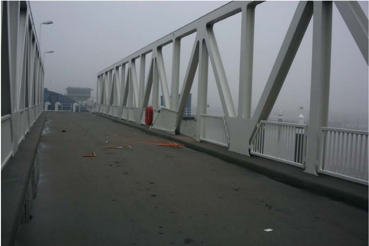
Abbildung 6: Schaden am Sperrwerk
