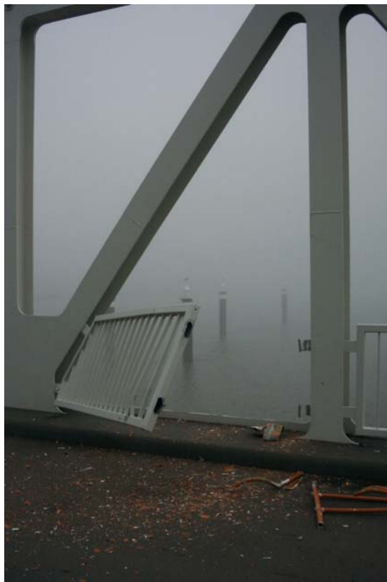
Abbildung 7: Detaillierter Schaden am Sperrwerk
