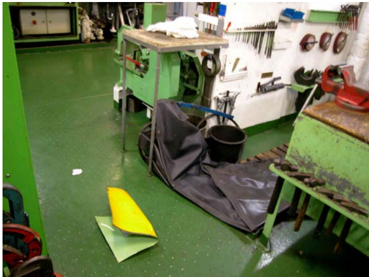
Abbildung 6: abgerissener Vorhang und stark deformierte Armaturenschranktür
