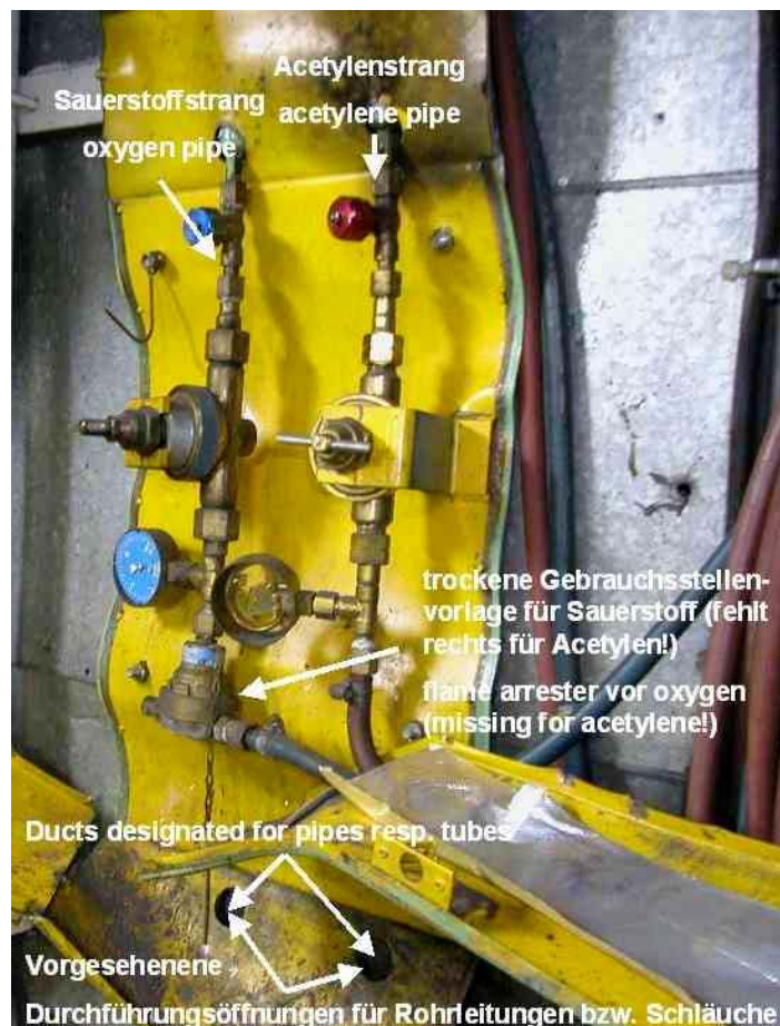
Abbildung 10: detonierter Armaturenschrank (Ansicht 2)
