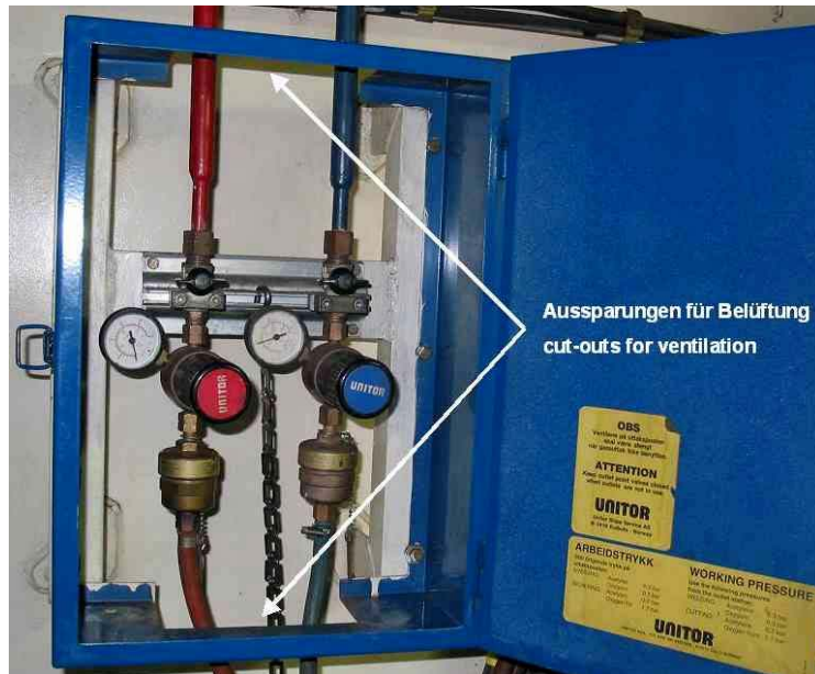
Abbildung 11: vorschriftsmäßig belüfteter Armaturenschrank
