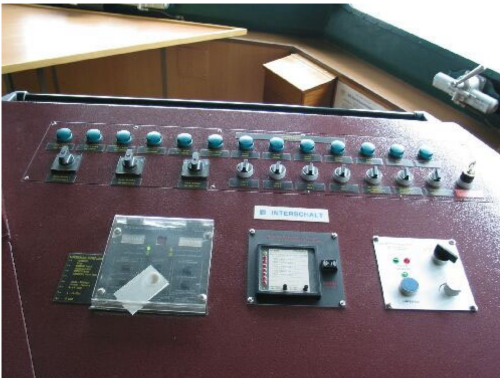
Abbildung 7, Schaltpult Decks- und Lukenbeleuchtung
