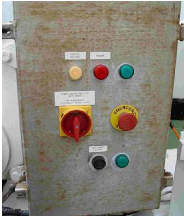
Abbildung 4: Schaltschrank; Bedienelemente Windenmotor
