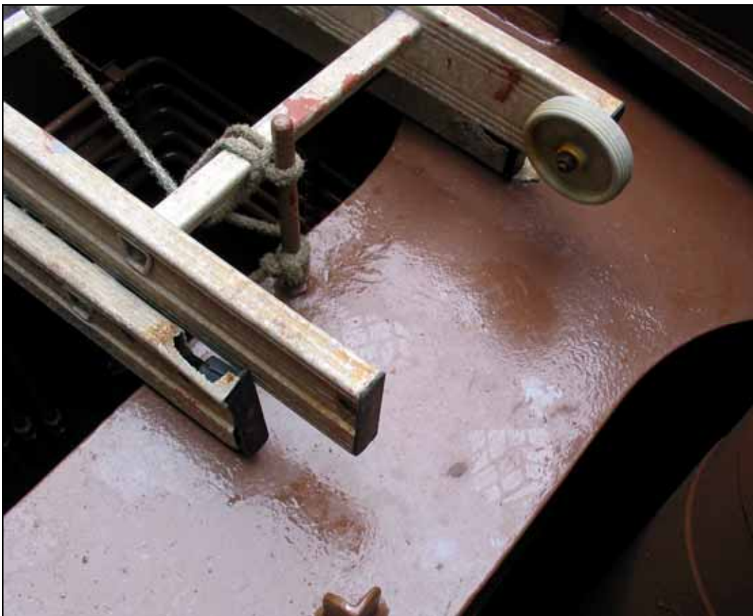
Abbildung 12: Korrosion und fehlende Rolle
