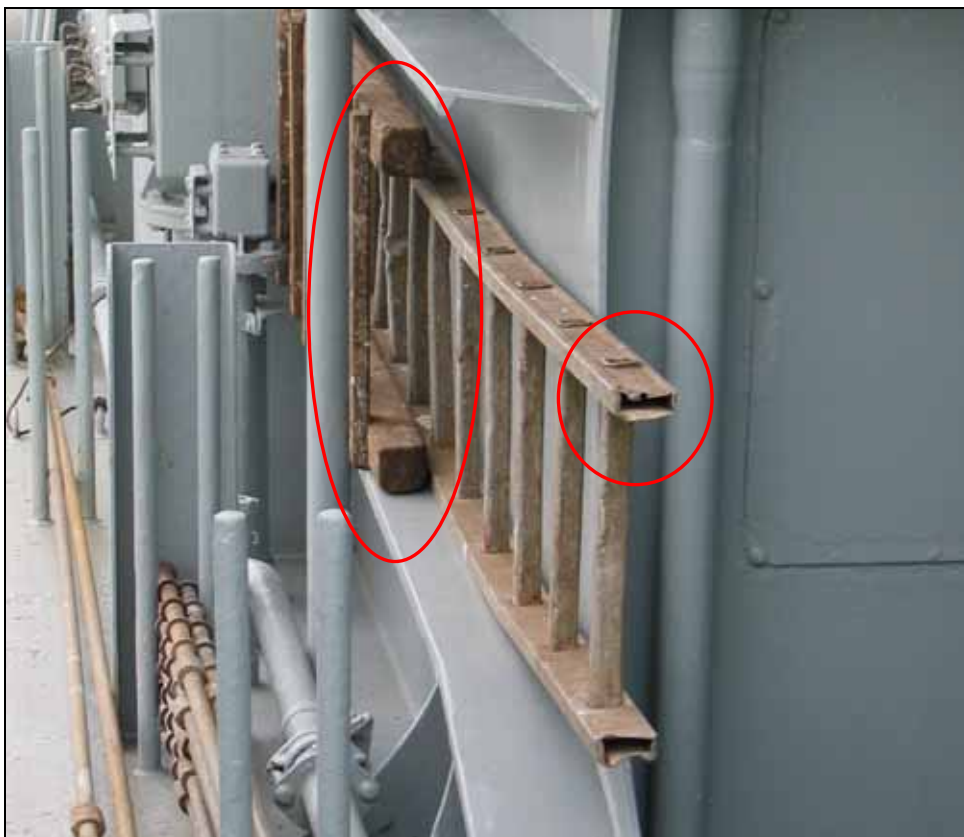
Abbildung 14: beschädigte Aluminiumleiter, Holzleiter mit aufgenagelten Sprossen
