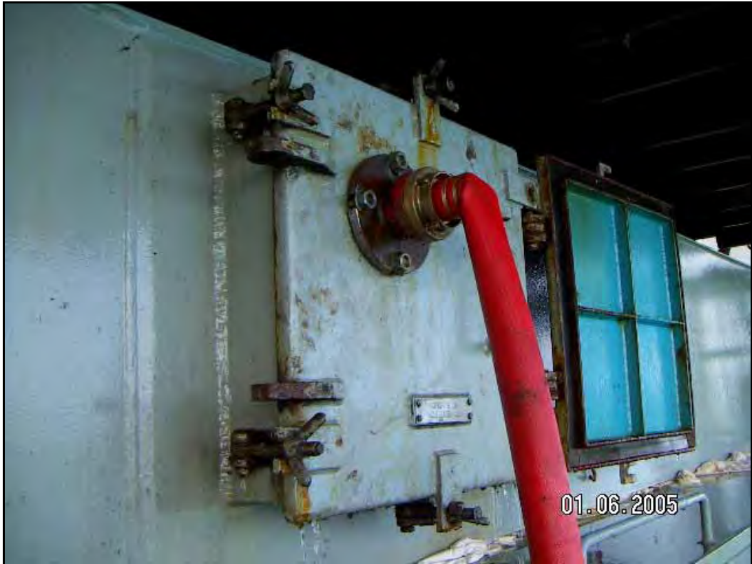
Abbildung 3: Zum Kühlen umgebaute Lüfterklappe
