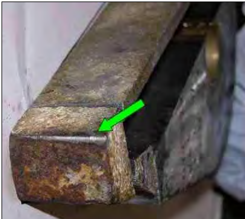
Abbildung 25: Ansicht vorderer Haken; asymmetrische Rundung, Verschleißkanten, starke Korrosion
