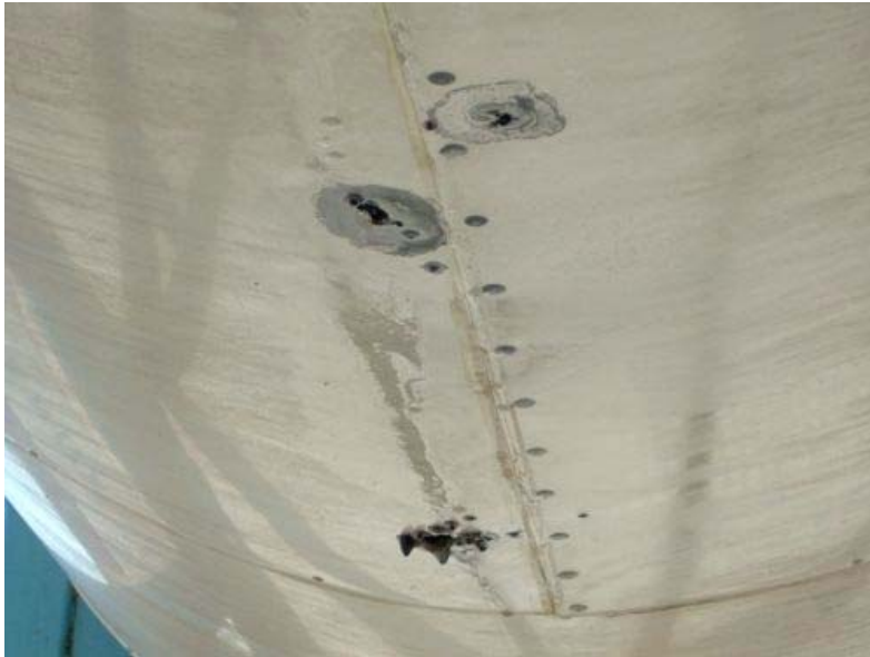
Abbildung 9: Löcher im Bodenbereich
