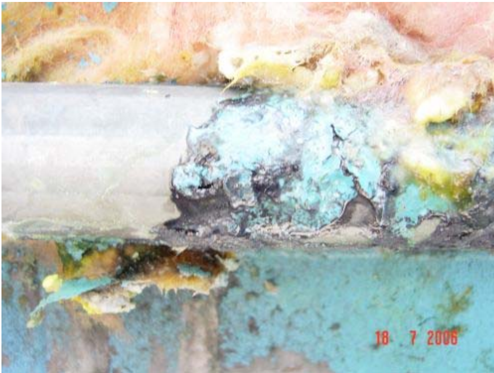
Abbildung 12: Zerfressene Leitung zum Heizsystem
