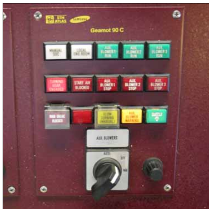
Abbildung 37: Schaltpult für Hilfsgebläse in der Brückenkonsole
