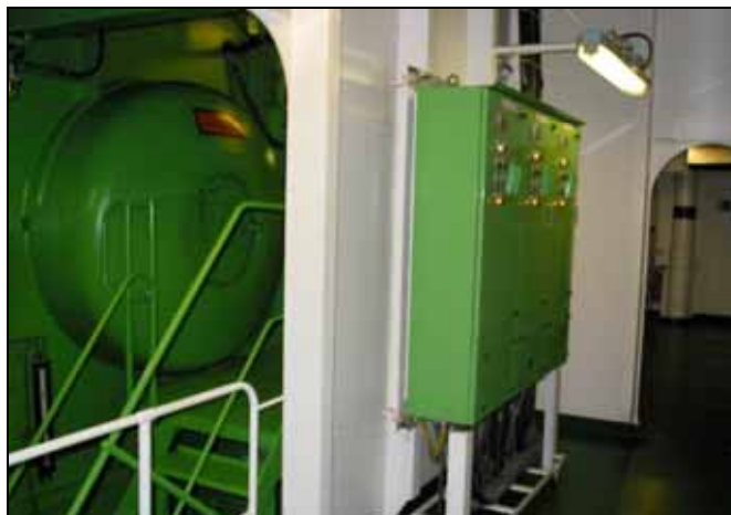
Abbildung 35: Hauptschaltkästen 1 bis 3 für Hilfsgebläse
