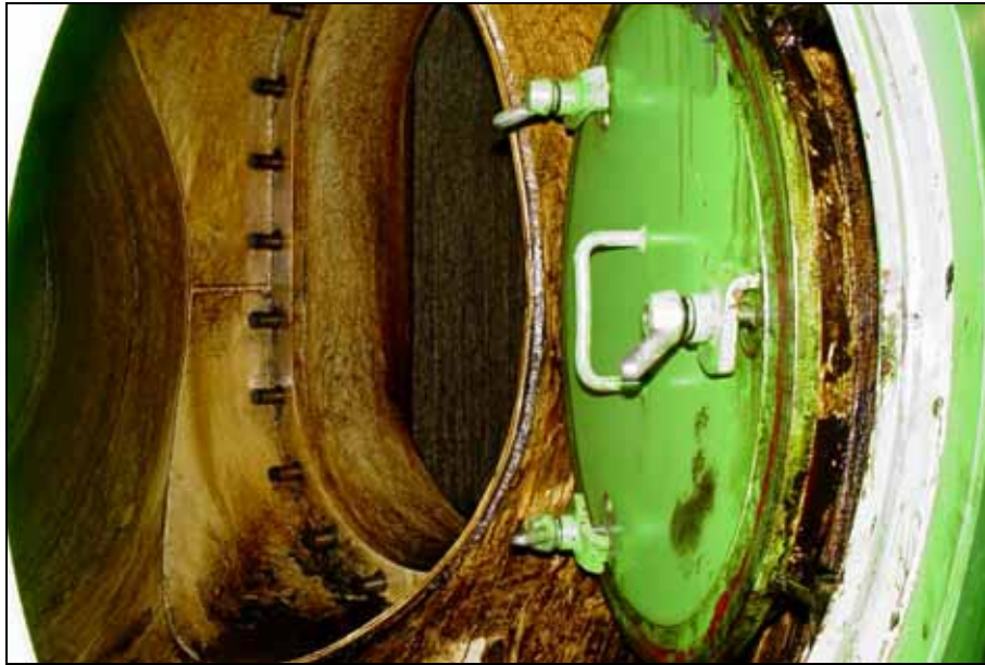
Abbildung 20: Mannlochdeckel Spülluftkanal Vorkante nach innen geschwenkt
