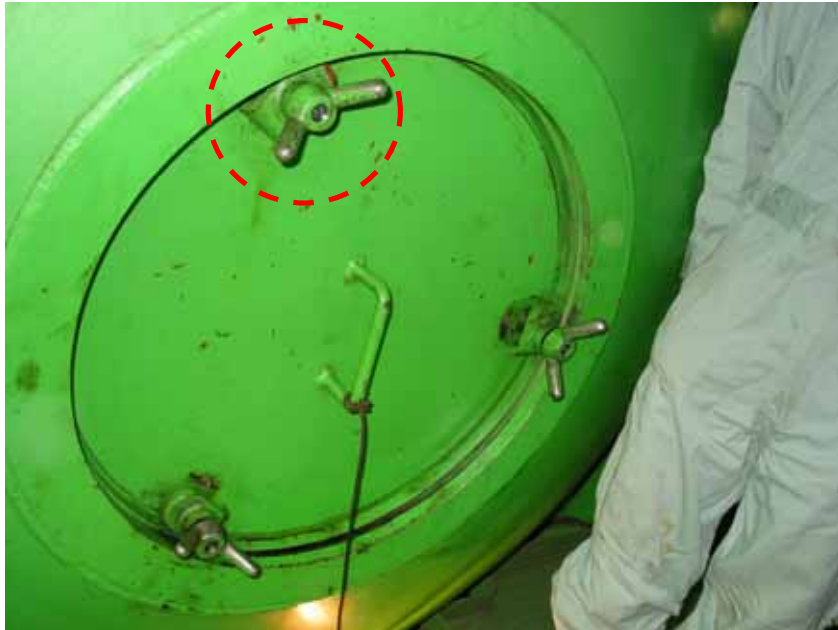
Abbildung 33: partieller Verschlusszustand – Gesamtaufnahme
