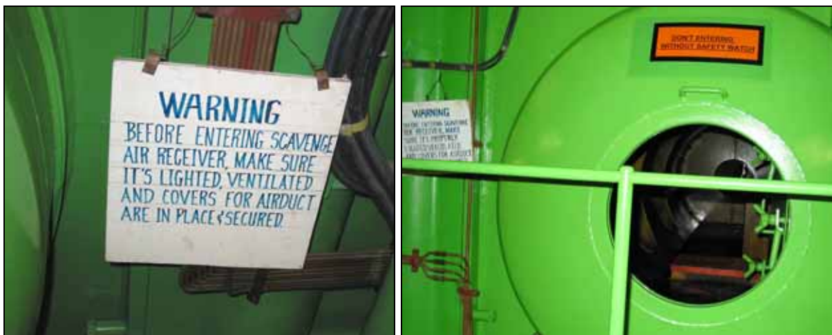
Abbildung 60: Warnhinweise am Lukeneinstieg
