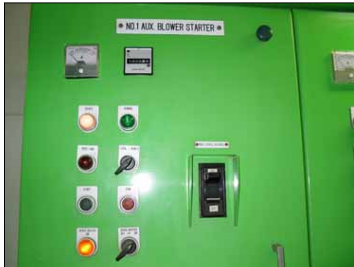
Abbildung 36: Hauptschaltkasten für Hilfsgebläse – Nahaufnahme
