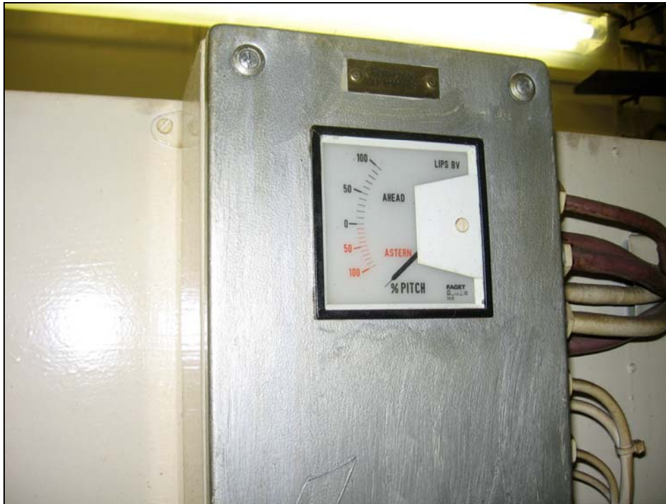
Abbildung 17: Steigungsanzeige im Maschinenraum nach der Kollision
