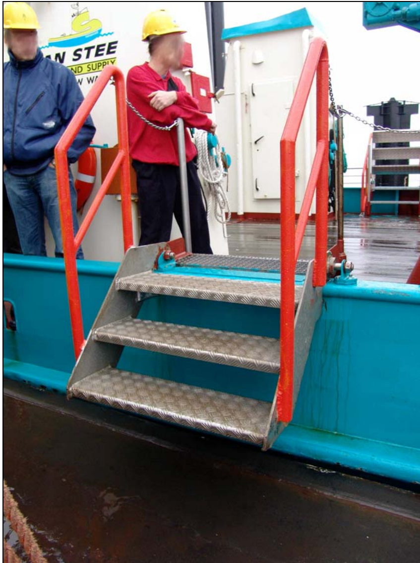
Abbildung 7: Treppe vom Ponton aus gesehen; linkes Geländer, Pfosten und Handlauf nach dem Unfall nachgerüstet
