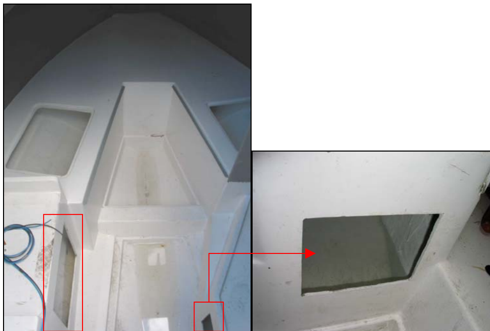
Abbildung 12: Nachträglich eingefügte Öffnungen in der Kabine
