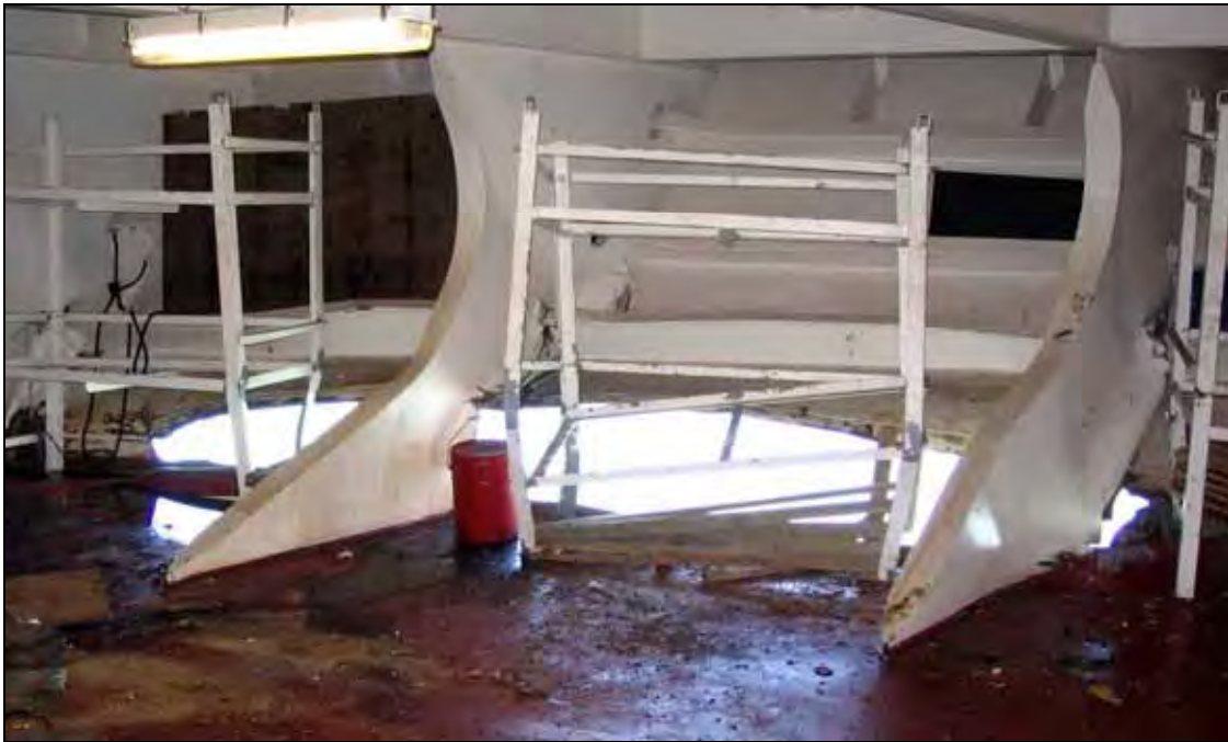
Abbildung 17: Riss im Schiffsrumpf der HANJIN GOTHENBURG am 21. September 2007
