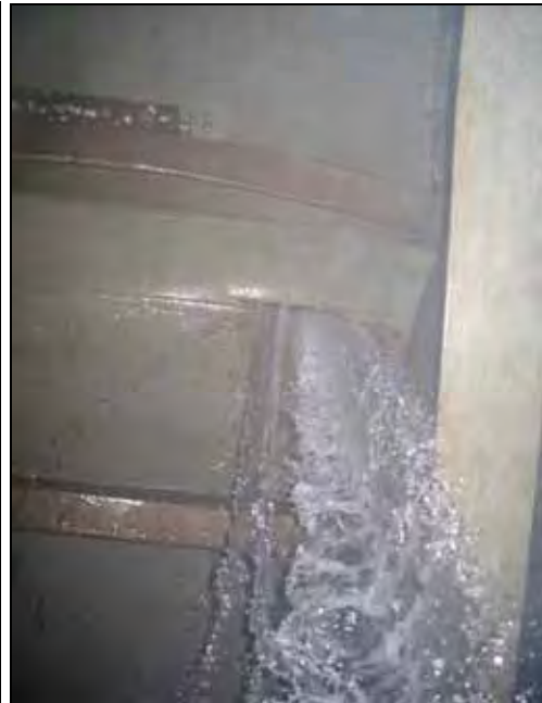
Abbildung 15: Riss im Tieftank Nr. 1
