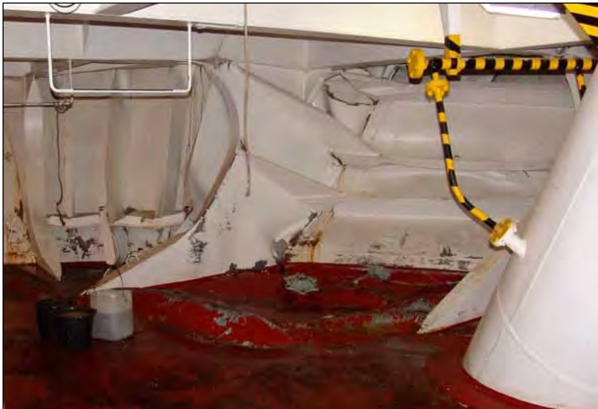
Abbildung 16: Kabelgatt der HANJIN GOTHENBURG
