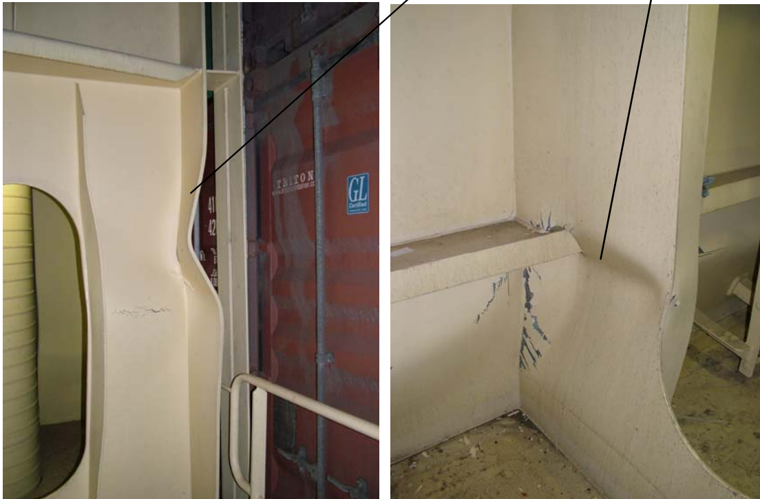
Abbildung 5: Schäden am Rahmenspant
