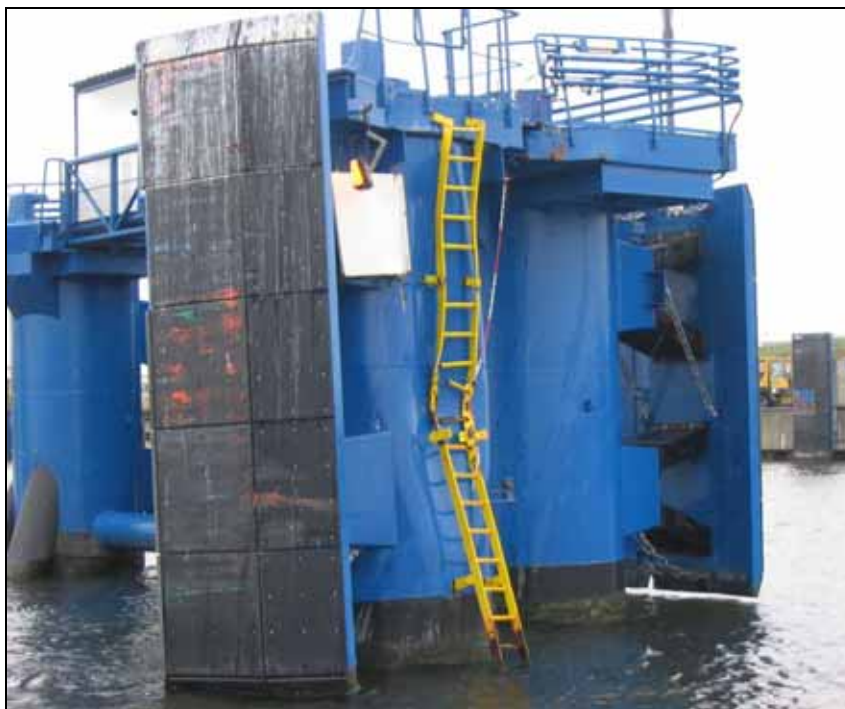
Abbildung 8: Schaden am vordersten Abweiser
