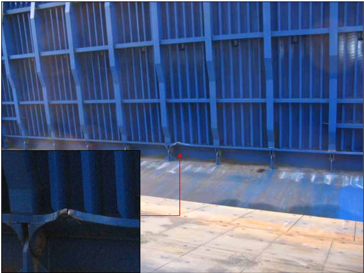
Abbildung 5: Schaden an der Heckrampe der FINNLADY
