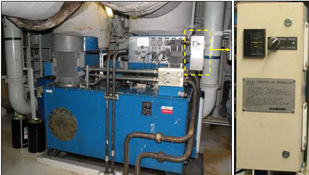
Abbildung 22: Verstellpropellereinheit im Maschinenraum
