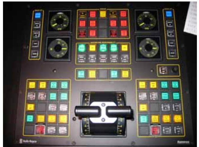
Bild 2: Nocken-Fahrstand - Hauptantriebs-Überwachungstableau mit Fahrhebel
