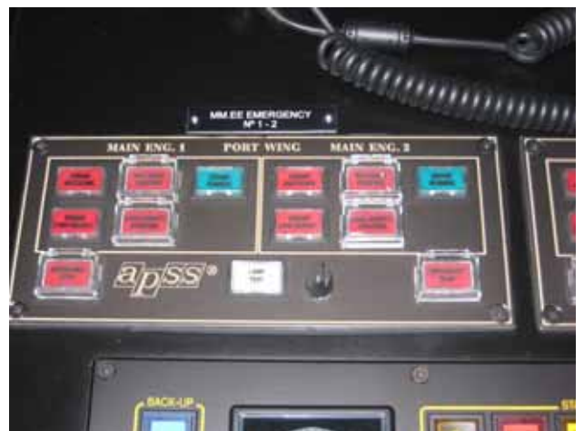
Bild 4: Nocken-Fahrstand - Notfall Tableau HM 1 und HM 2 (Emergency panel)
