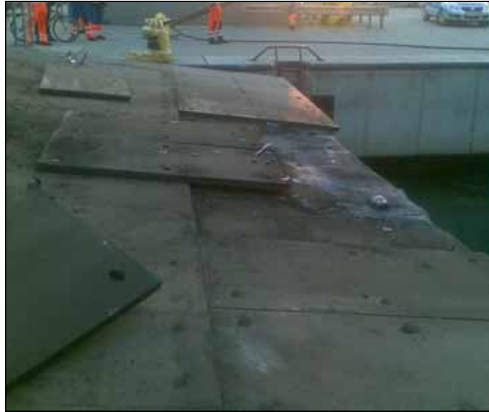
Abbildung 9: Beschädigte Beplattung auf der Verladebrücke
