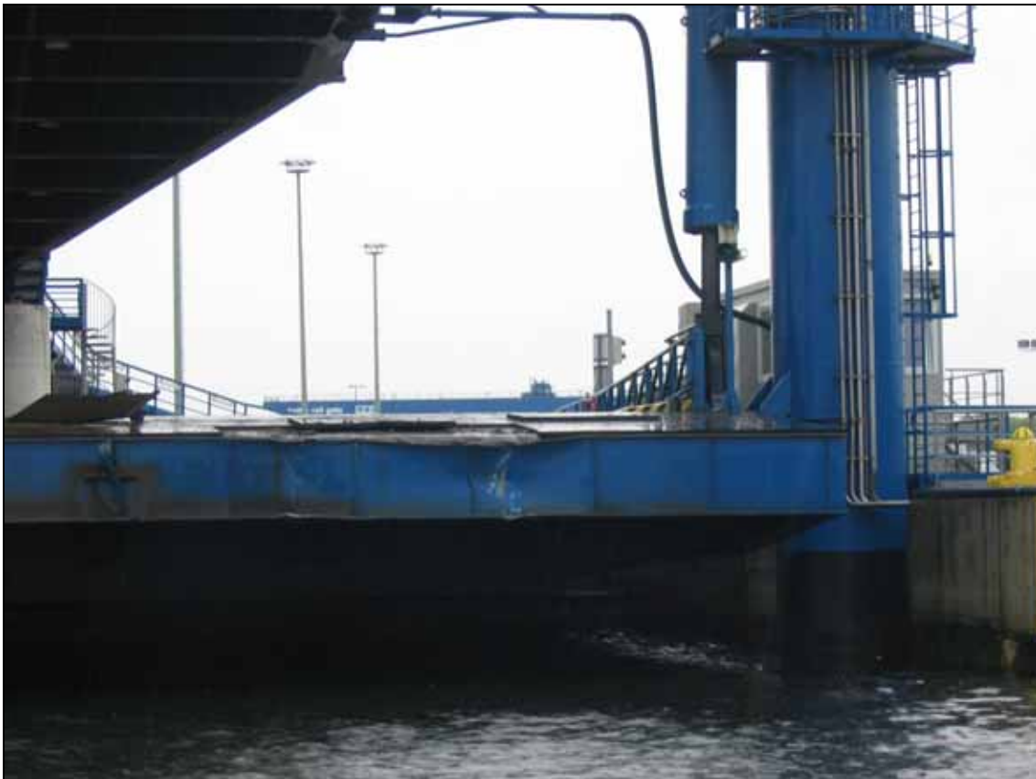
Abbildung 10: Schaden am Stahlunterbau der Verladebrücke
