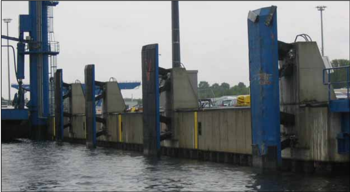
Abbildung 7: Schäden an den Abweisern
