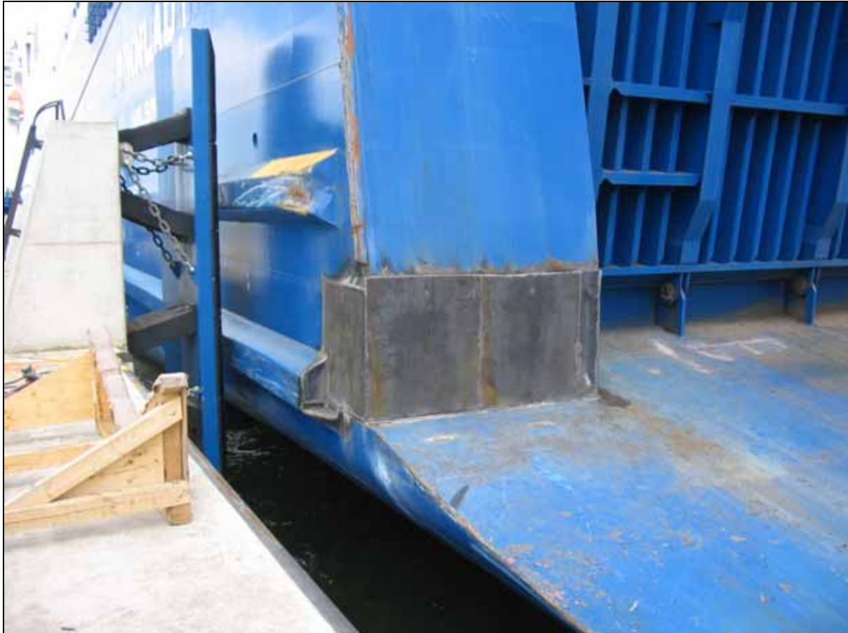
Abbildung 11: Notreparatur des beschädigten Kofferdamms
