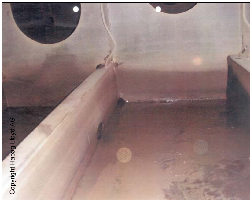
Abbildung 5: Bodenschaden mit Verformungen
