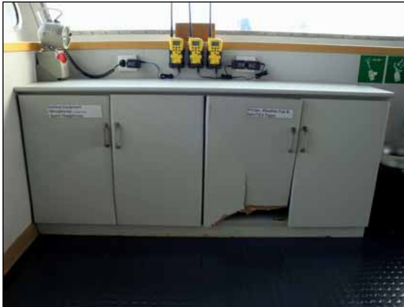
Abbildung 6: durch Aufprall beschädigter Schrank 16
