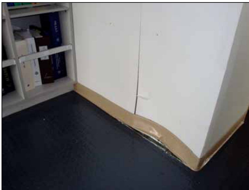
Abbildung 7: im Bodenbereich deformierte Innenraumverkleidung 17
