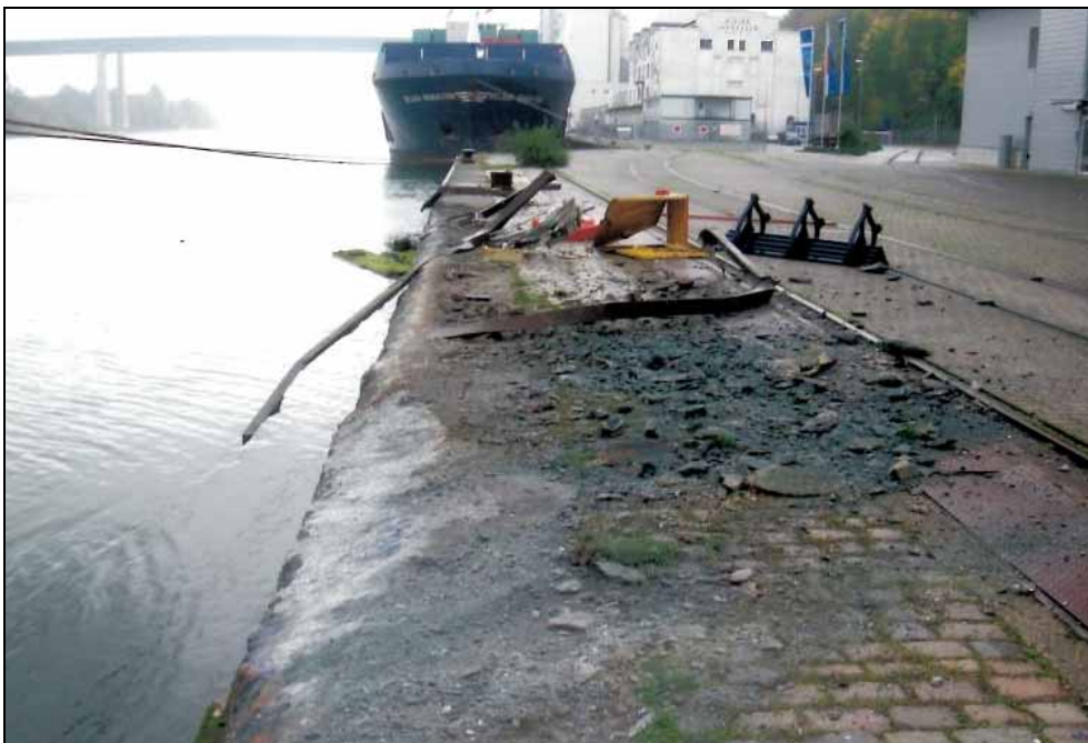
Abbildung 6: Schaden an der Pier
