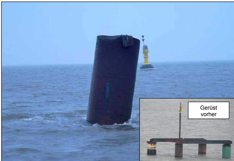
Abbildung 8: Beschädigter Dalben des Führungsgerüsts
