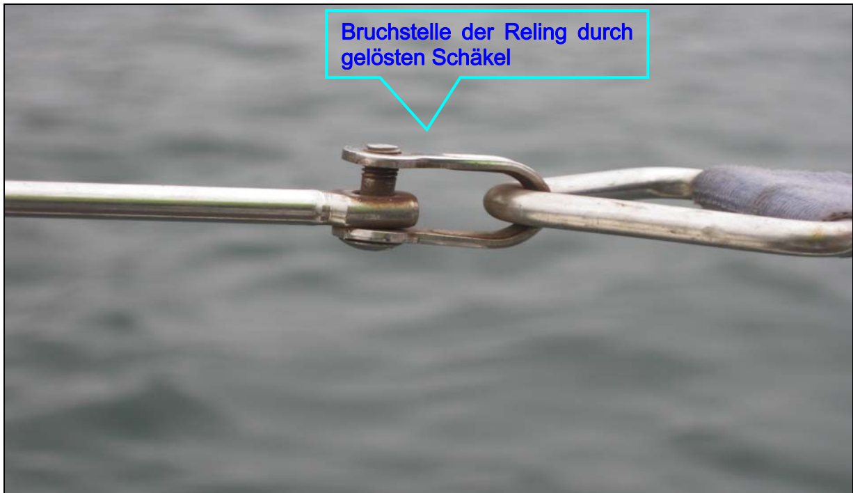
Abbildung 9: Detailansicht des Schäkels (hier intakte Reling Stb.)
