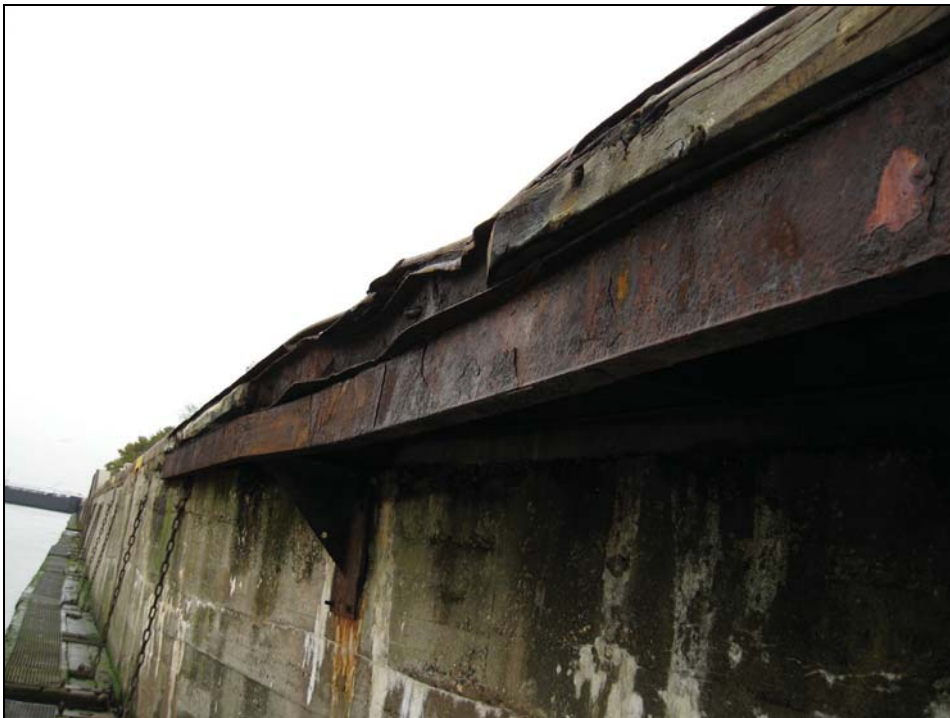
Abbildung 8: Beschädigung von unten gesehen
