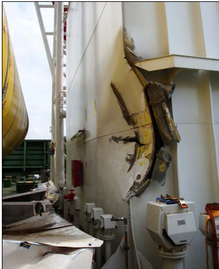
Abbildung 7: Beschädigung Jacking House 1 10
