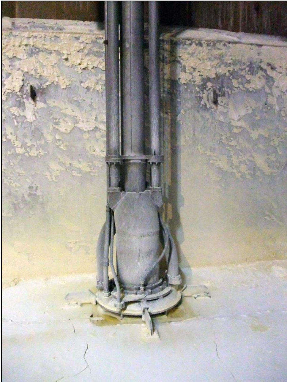
Ladetank Nr. 2, Saugbrunnen der Ladungspumpe
