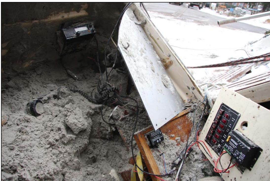
Abbildung 23: Seefunkanlage und Regeltechnik in der Kajüte
