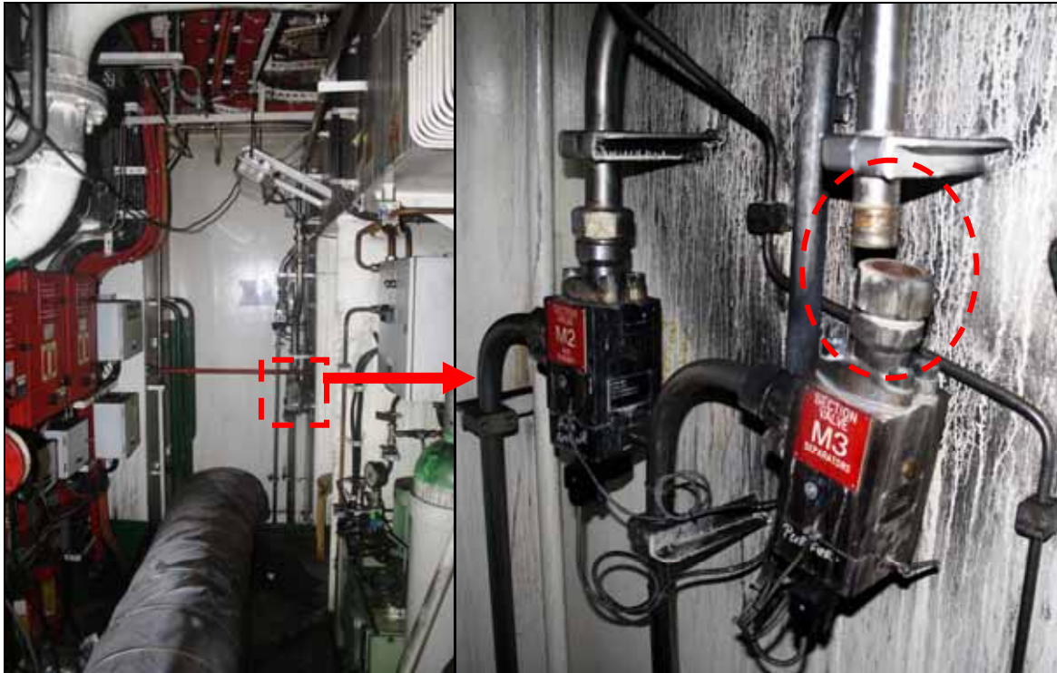
Abbildung 88: Getrennte Druckleitung des Sprinklersystems nahe des Maschinenkontrollraums
