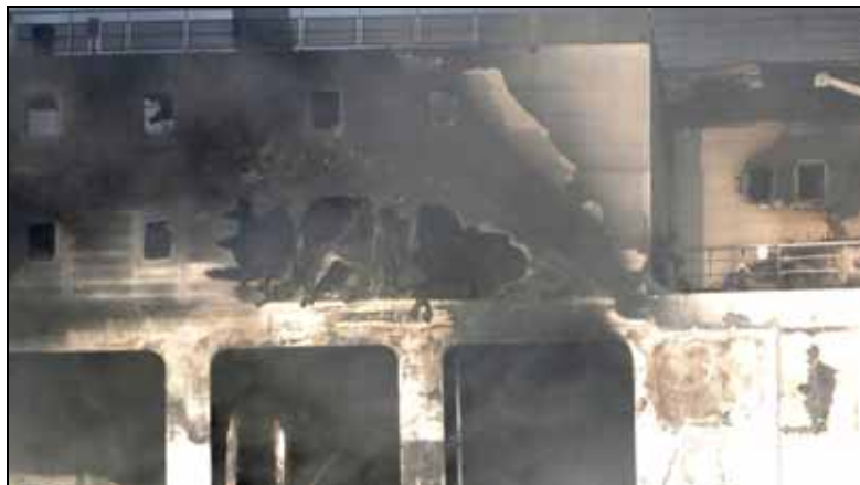
Abbildung 115: Loch in der Außenwand auf Deck 7, aufgenommen am 9. Oktober 2010 um 14:56 Uhr
