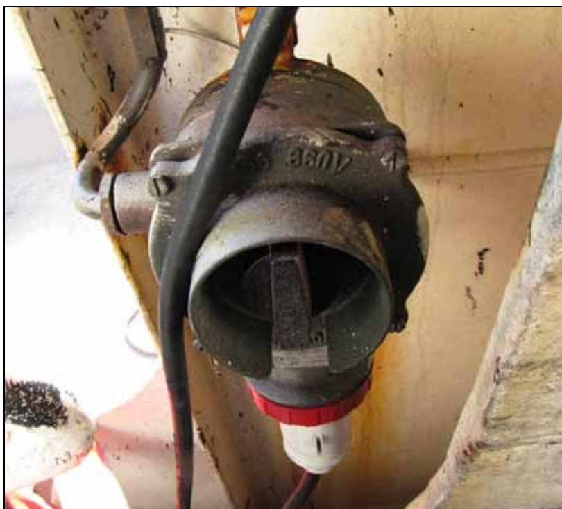
Abbildung 39: Thermisch wenig belastete Steckdose mit eingestecktem Stecker, Deck 6, Spur 8
