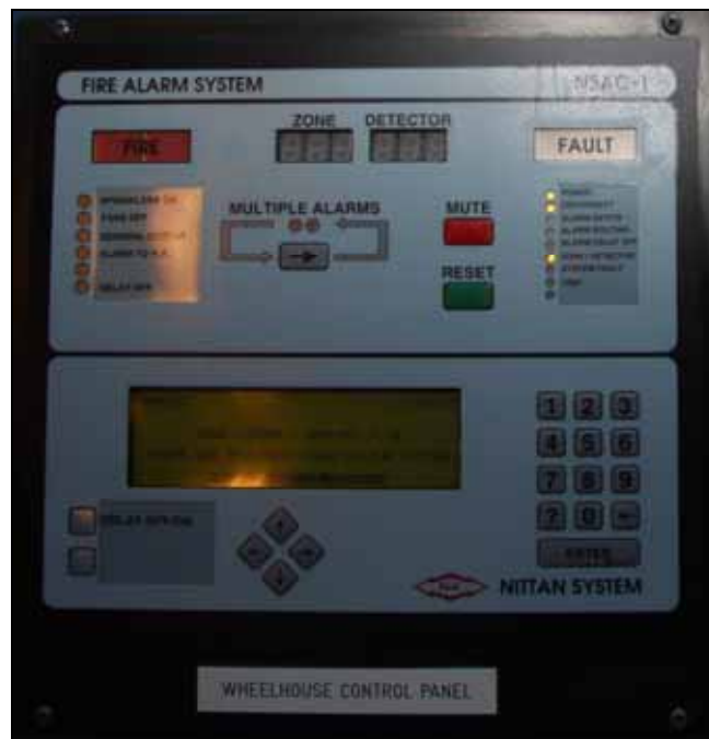
Abbildung 68: Bedienfeld des baugleichen Feuermelde- und -anzeigesystems auf dem Schwesterschiff DANA SIRENA
