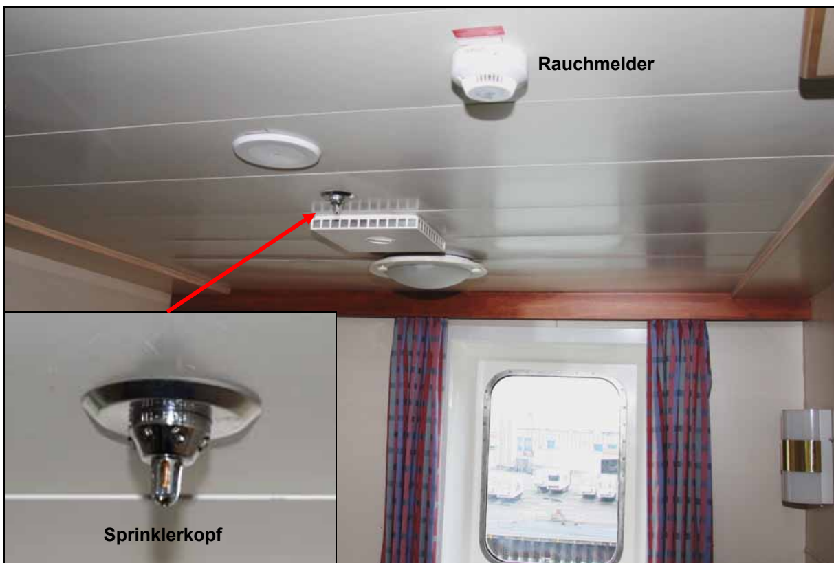
Abbildung 87: Rauchmelder und Sprinklerkopf in einer vergleichbaren Kabine der DANA SIRENA
