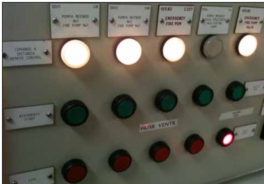
Abbildung 84: Bedienfeld für die Feuerlöscher- und Sprühflutpumpen im Maschinenkontrollraum der DANA SIRENA bei veränderter Ventilstellung an der Schalttafel für die Sprühflutpumpe
