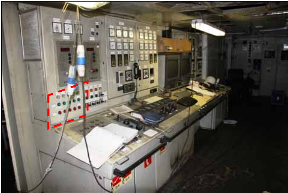
Abbildung 81: Bedienfeld für die Feuerlöscher- und Sprühflutpumpen im Maschinenkontrollraum der LISCO GLORIA
