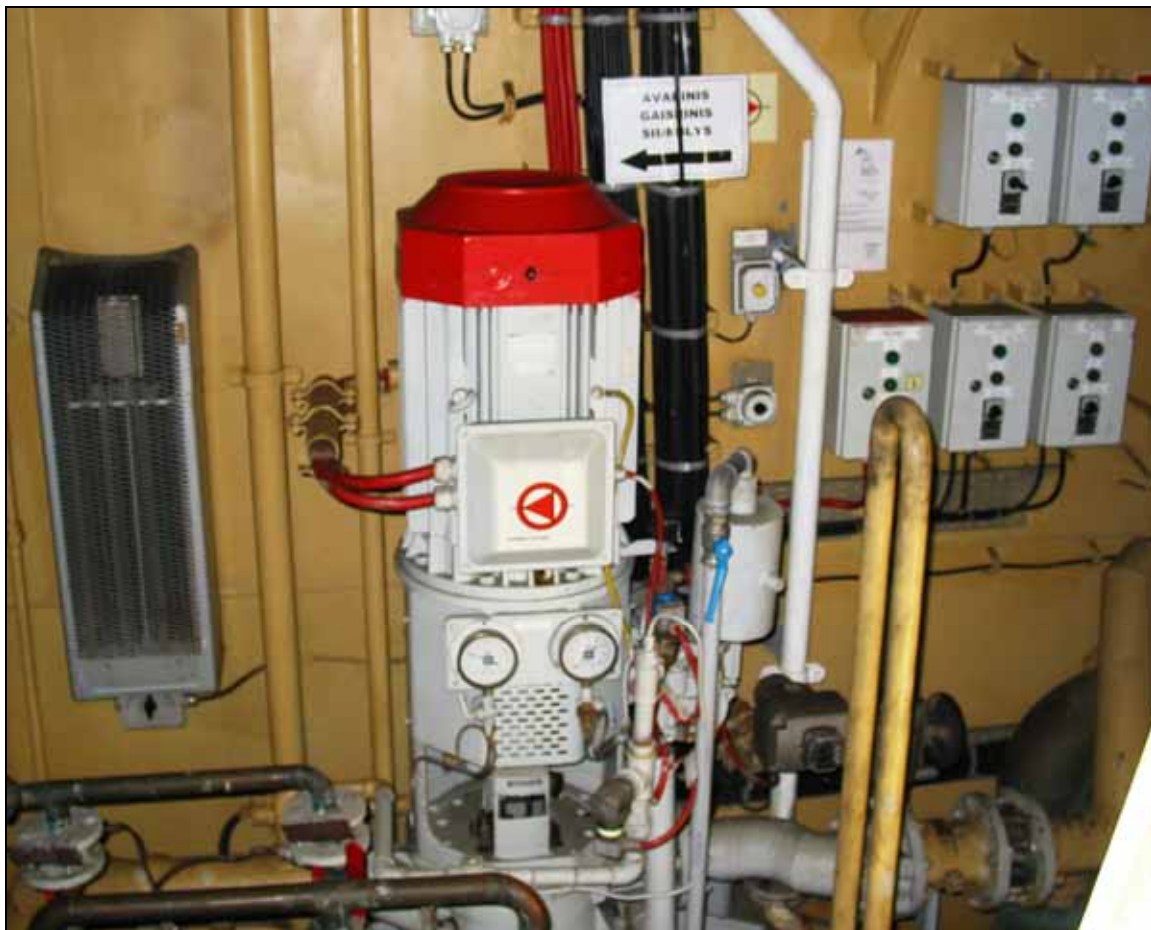
Abbildung 90: Notfall-Feuerlöschpumpe im Vorschiffsbereich der LISCO GLORIA
