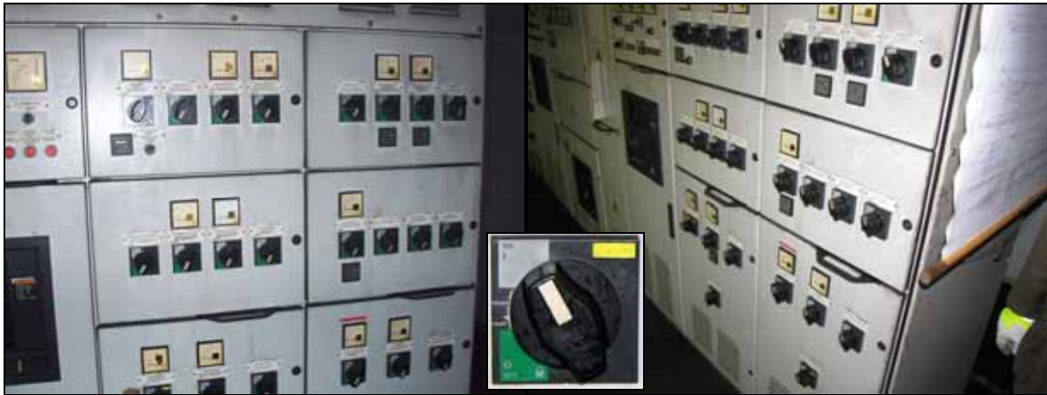
Abbildung 43: Rechter Bereich der Hauptschalttafel am 11. Oktober 2010 (links) und am 25. Oktober 2010 (rechts)
