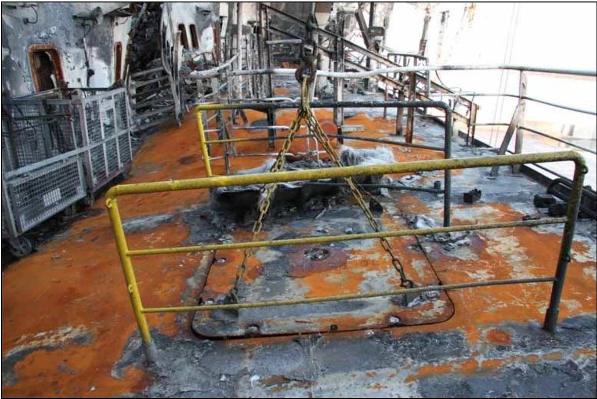
Abbildung 66: Lukenöffnung auf Deck 7 - nach dem Unfall
