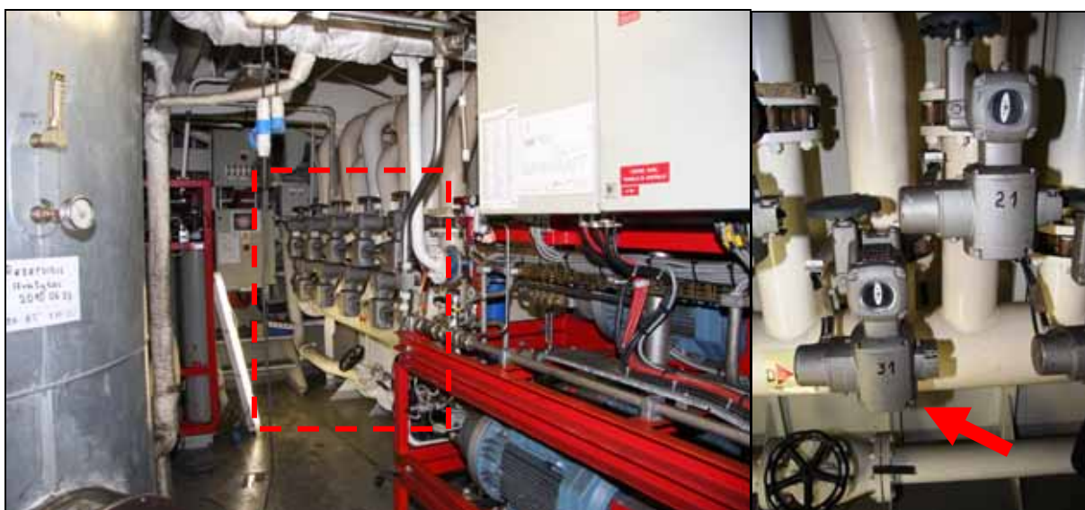
Abbildung 85: Sprinklerraum an Bord der LISCO GLORIA
