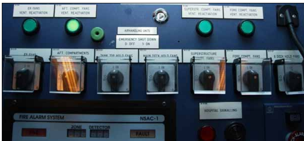
Abbildung 72: Vergleichbare Notfallabschaltung für das Lüftungssystem auf der DANA SIRENA
