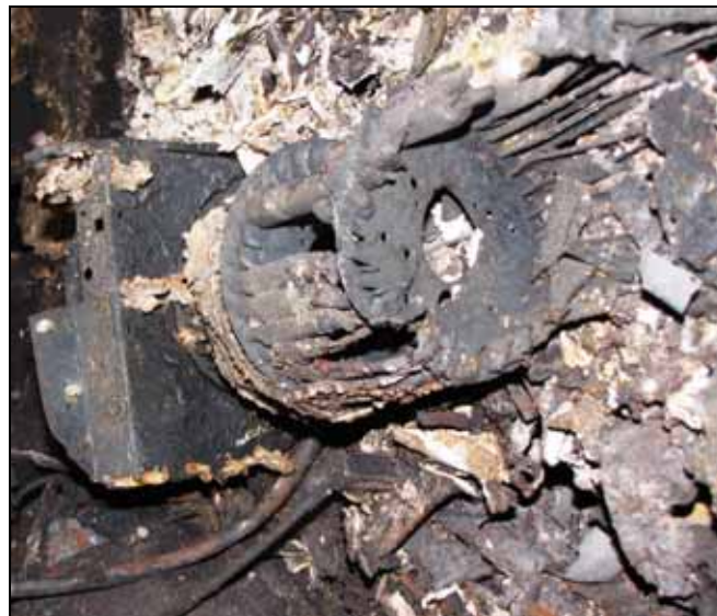
Abbildung 37: Überreste des Ventilators des Kühlaggregates
