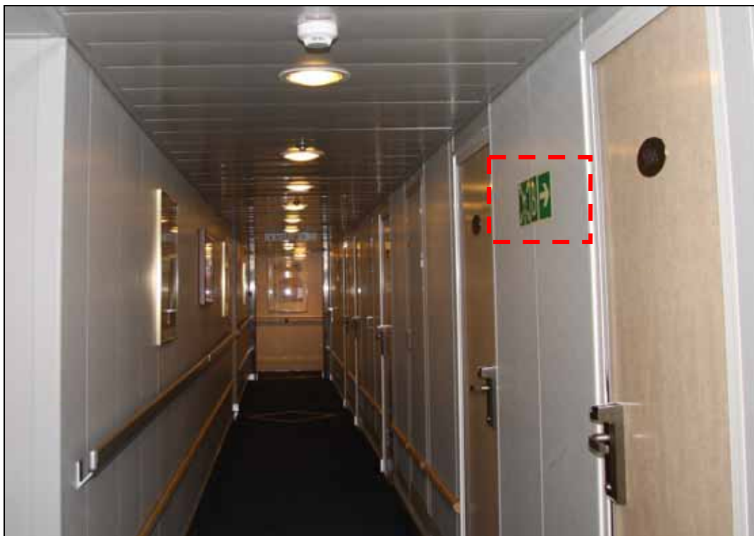
Abbildung 50: Fluchtweg-Piktogramm im Kabinenbereich auf der DANA SIRENA
