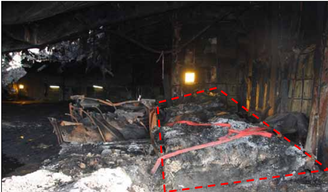
Abbildung 34: Überreste des Lkw mit Kühlaufleger auf Spur 8
