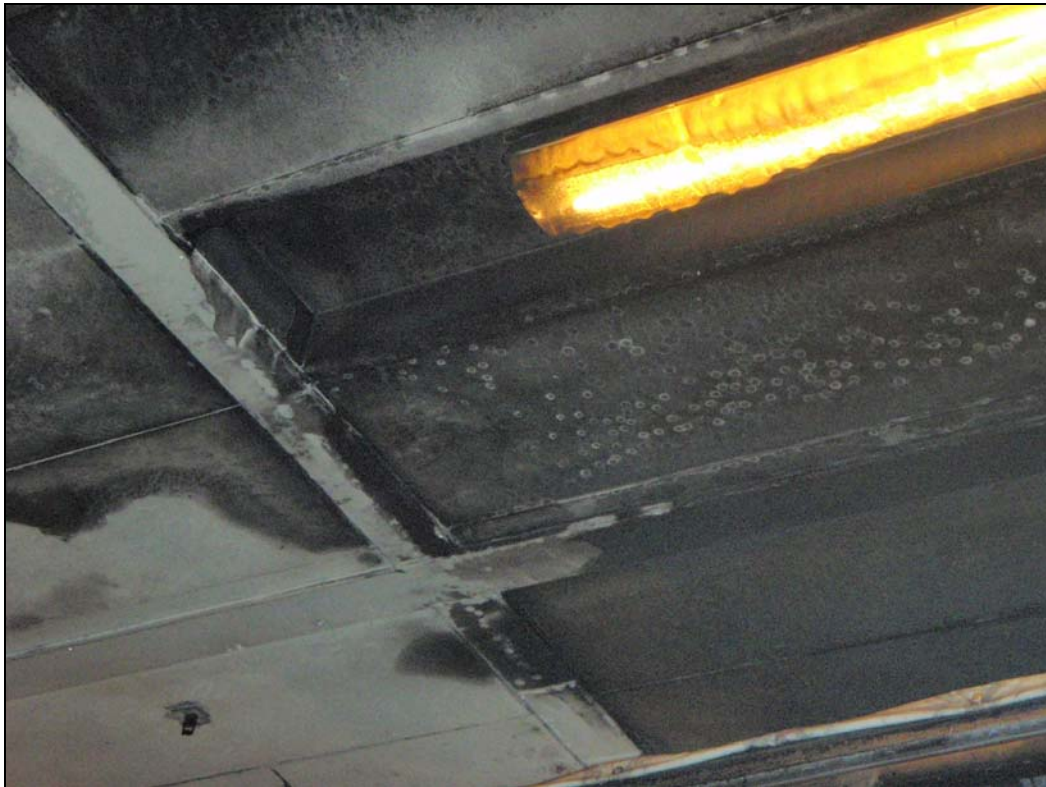
Abbildung 5: Detailaufnahme der Brandspuren an der Decke
