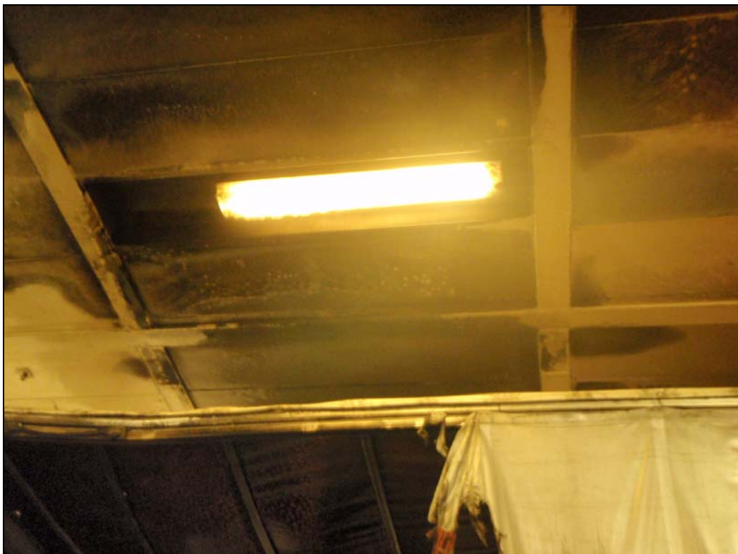
Abbildung 4: Brandspuren an der Decke über dem Brandort
