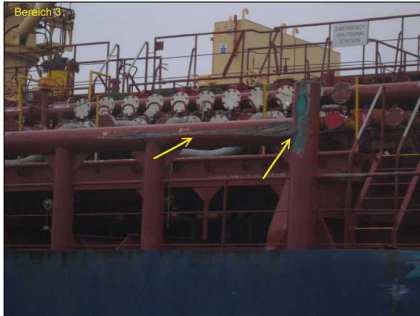
Abbildung 10: CLIPPER MIKI Schadensbereich 3
