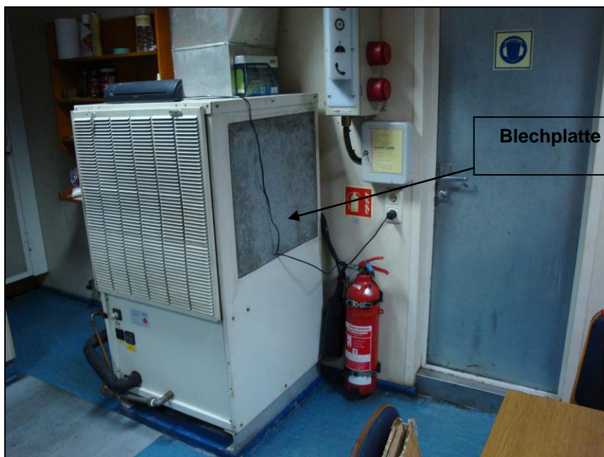
Abbildung 4: Lüfter mit verschlossener Blechplatte
