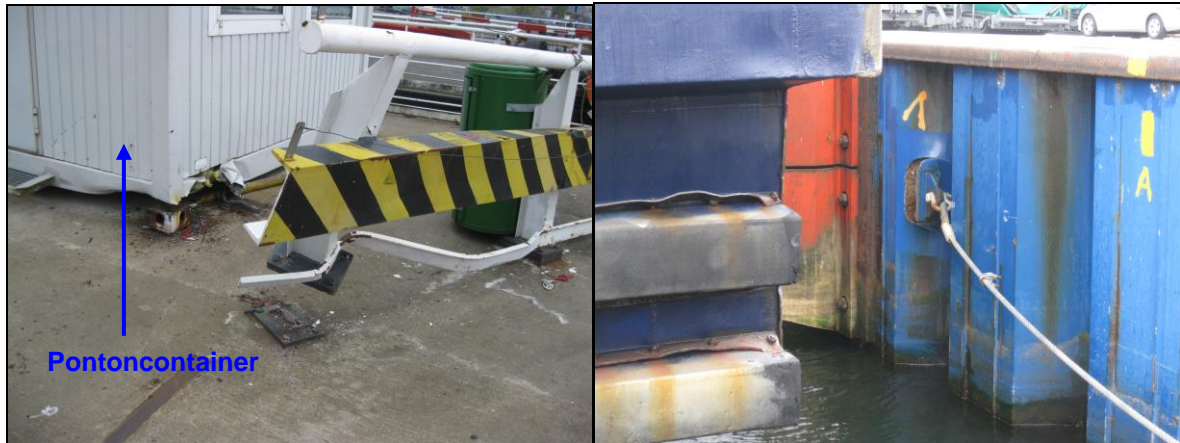
Abbildung 16: Beschädigte Leitplanke und beschädigte Spundwand am Anleger
