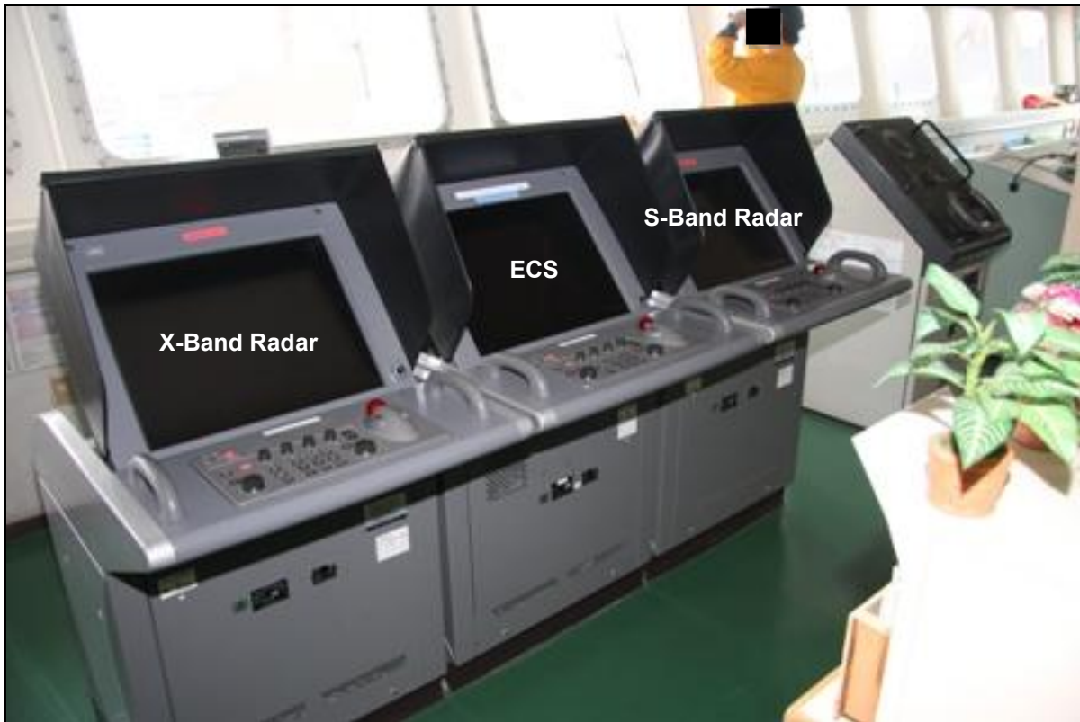
Abbildung 23: Brückenhaus der CORAL ACE, Radar- und ECS-Station
