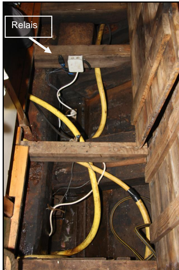
Abbildung 14: 12 Volt Pumpen, Schläuche und Elektroverkabelung
