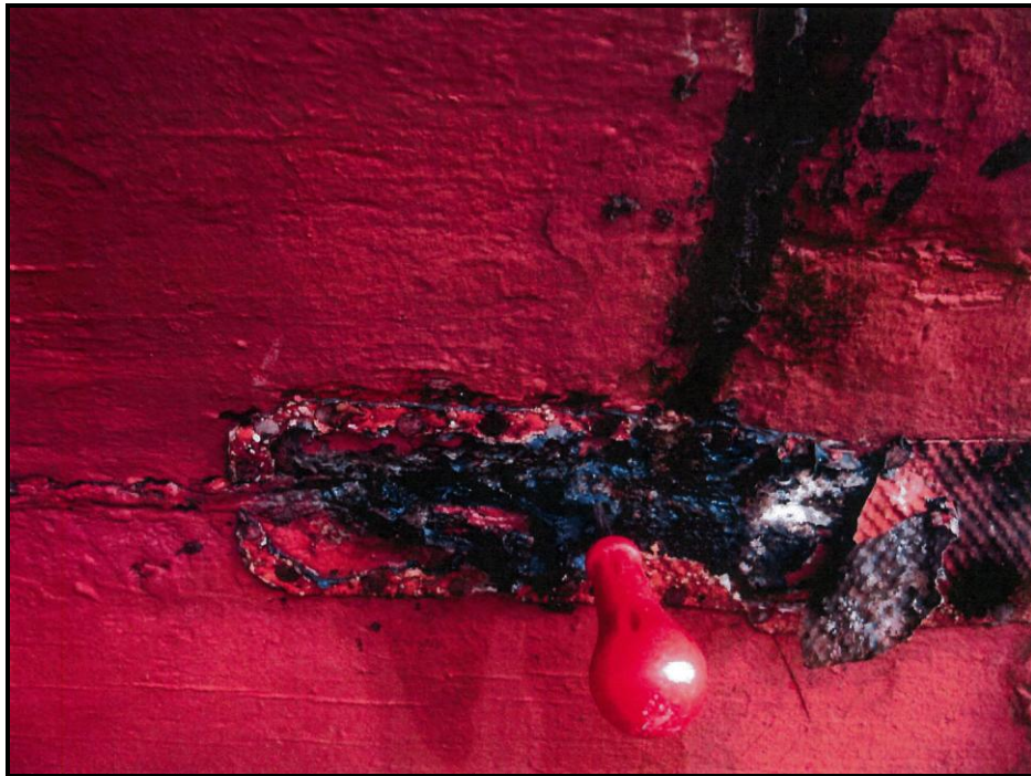
Abbildung 7: Plankenstöße mit Blech vernagelt
