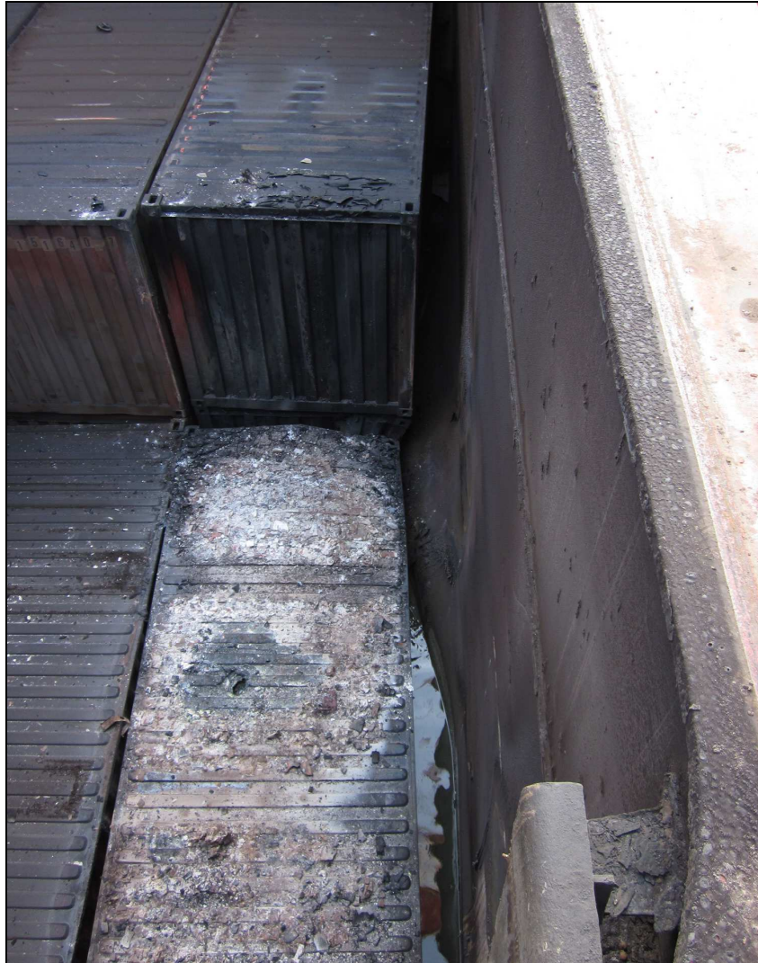
Abbildung 16: Wassereintritt und Hinweise auf Hitzeentwicklung in Laderaum 5
