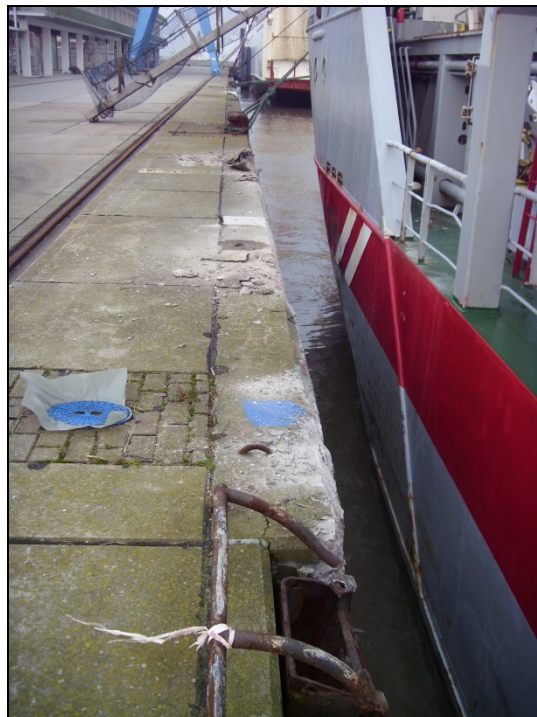
Abbildung 8: Schäden an der Pier
