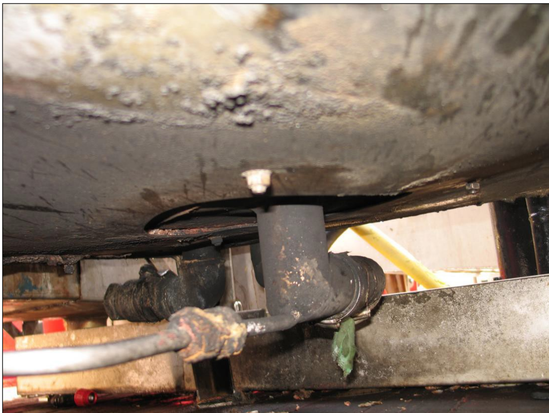
Abbildung 9: Brennstoffanschluss über die Gebläseleitung
