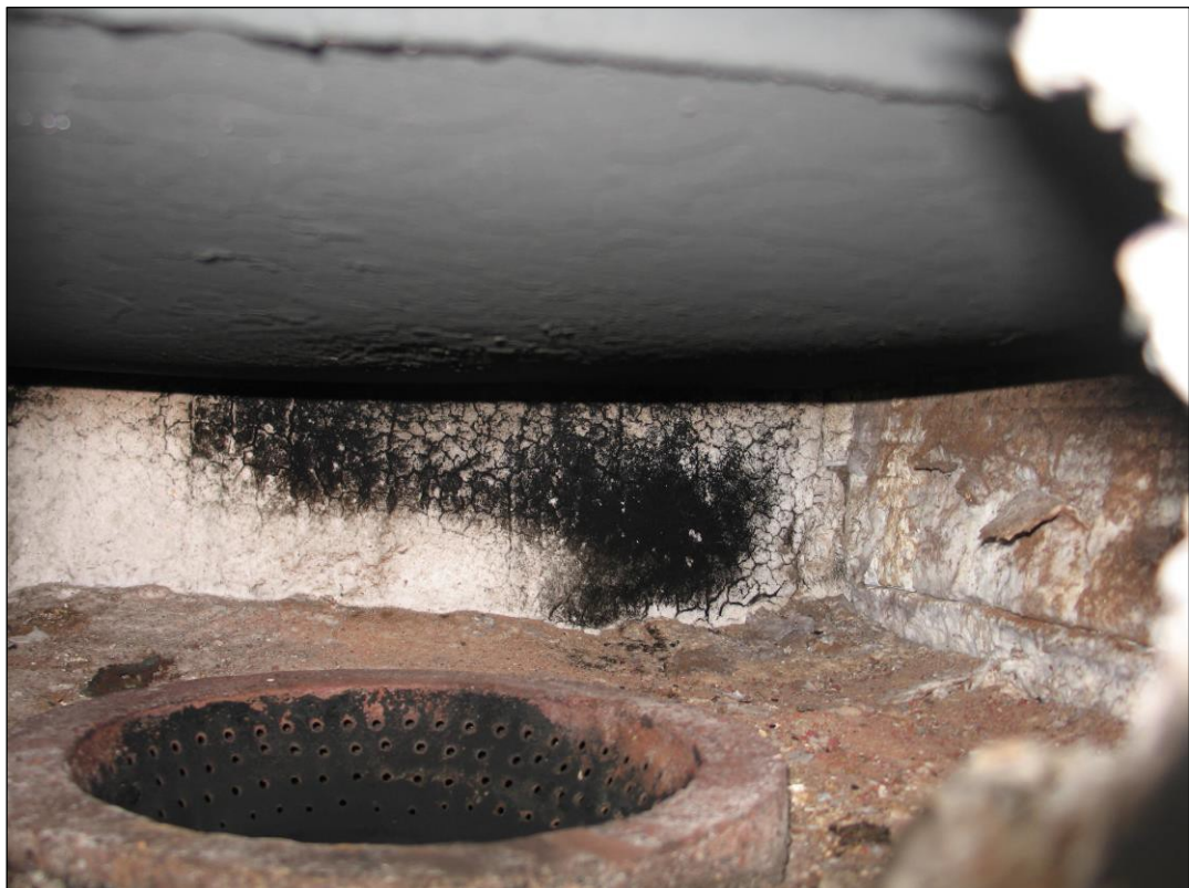
Abbildung 11: isolierter Innenraum der Brennkammer
