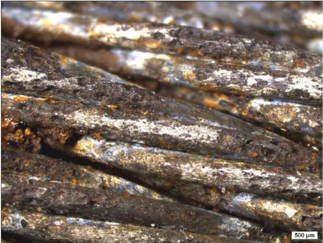
Abbildung 27: Korrodierte Oberfläche des Seiles nach Säuberung mit Waschbenzin
