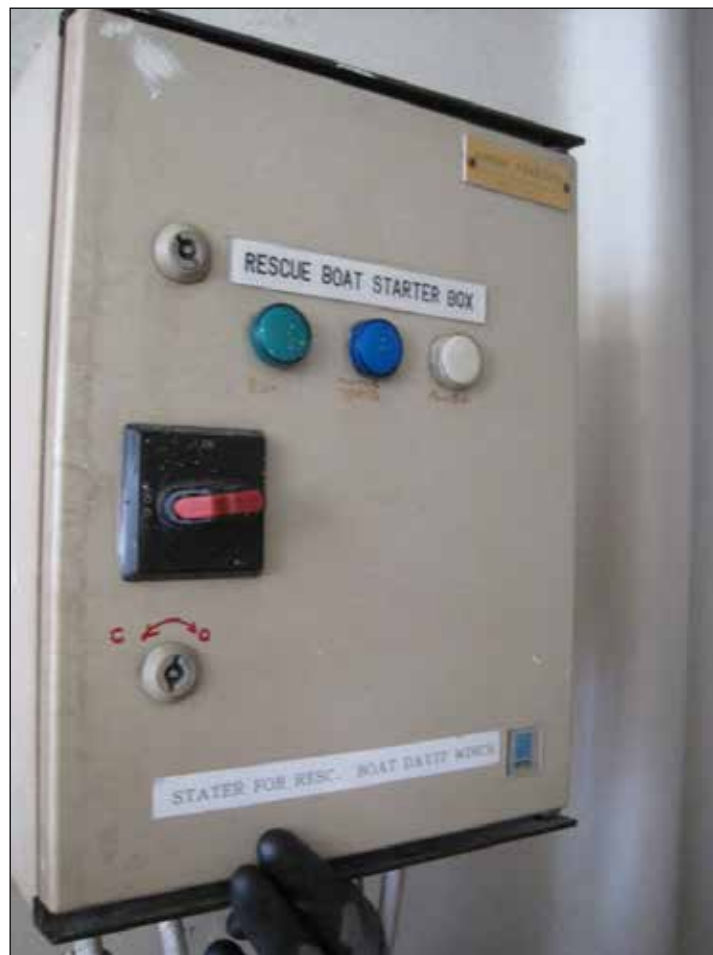
Abbildung 18: E-Schaltschrank auf dem Poop-Deck
