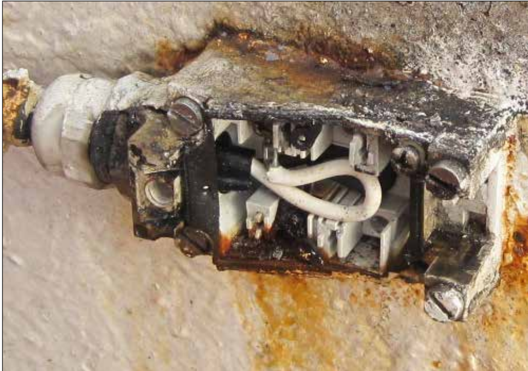
Abbildung 16: Korrodierter Endlagenschalter mit defekter Dichtung
