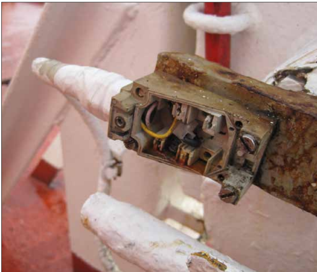
Abbildung 17: Korrodierter Schalter an der Winde
