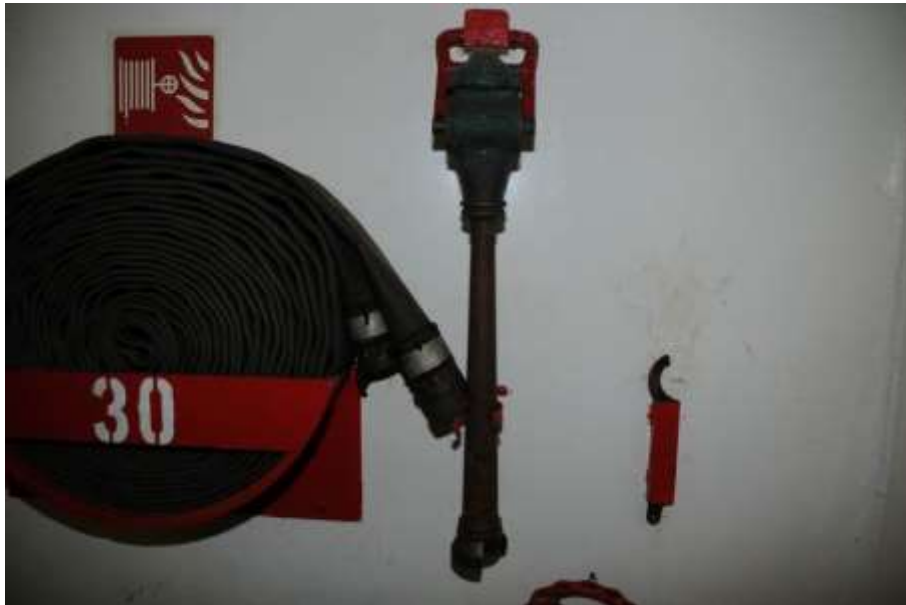
Abbildung 35: Beispiel für Lagerplatz eines Wasserlöschschlauches nebst Strahlrohr und Kupplungsschlüssel an einer Schiffswand
