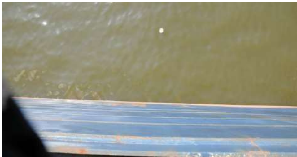
Abbildung 58: Keine thermisch bedingten Schädigungen der Bordwand im Bereich Bay 26 (hier: Backbordseite)
