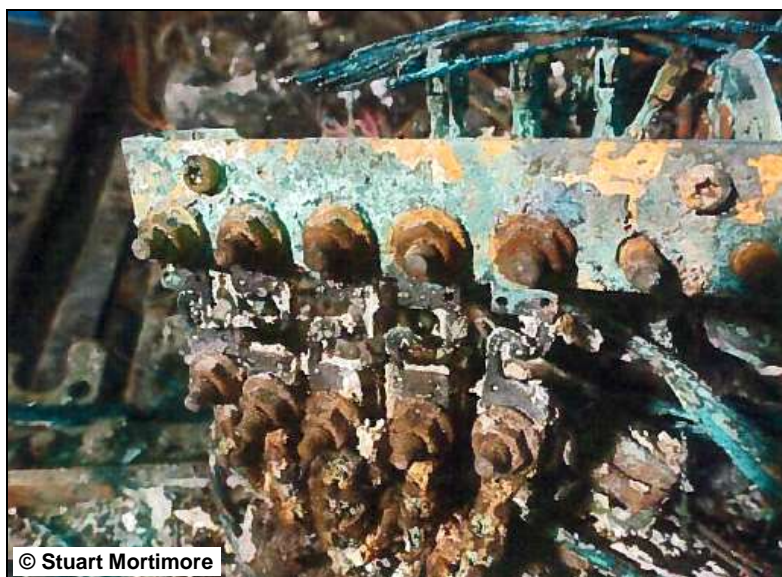
Abbildung 104: Nahaufnahme des Sicherungskastens im Motorraum des Fahrzeuges 5 A 77
