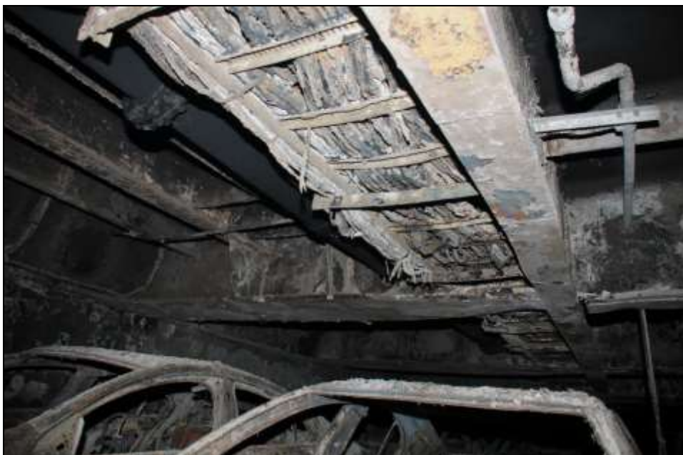
Abbildung 108: Kabelbahn über PKW 4 B
