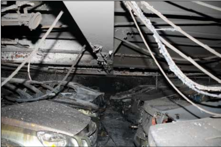
Abbildung 47: Thermische Belastungen an der Decke des Decks
