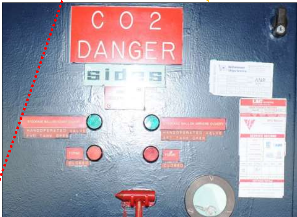
Abbildung 19: Auszug Bedienelemente der CO2-Anlage
