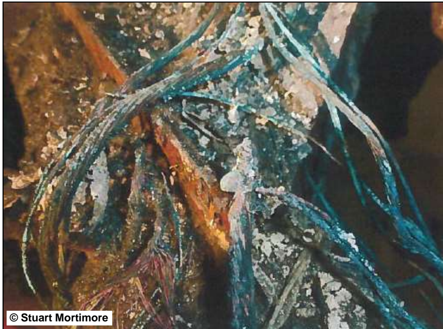
Abbildung 103: Beispiel einer durch elektrischen Strom verursachten Lichtbogenaktivität (2) 76
