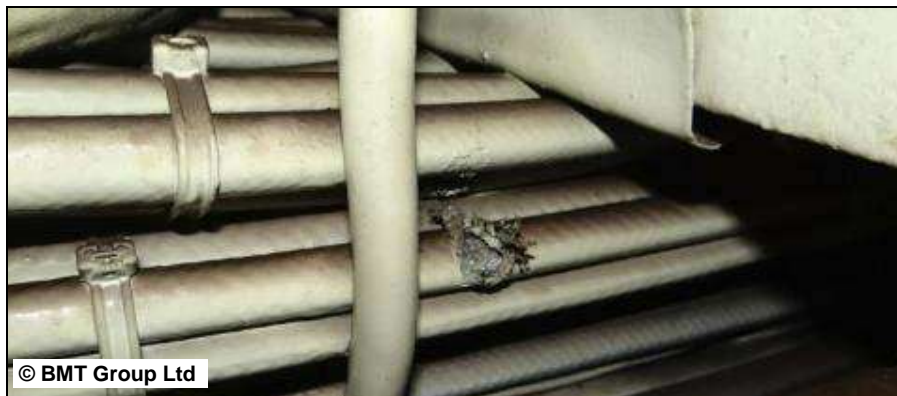
Abbildung 67: Beispiel für verschmorte Kabelisolierung (2) 40
