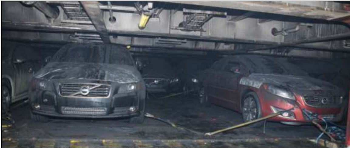
Abbildung 53: Verrußte Fahrzeuge im Außenbereich
