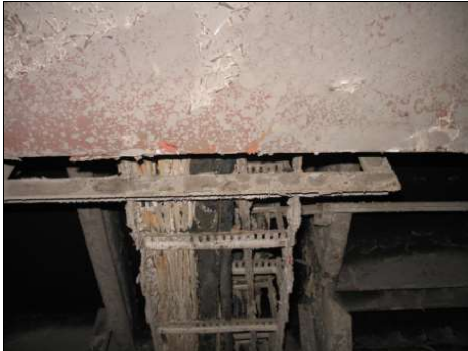
Abbildung 107: Kabelbaum über der Entstehungsstelle, gleichförmige Brandbeaufschlagung
