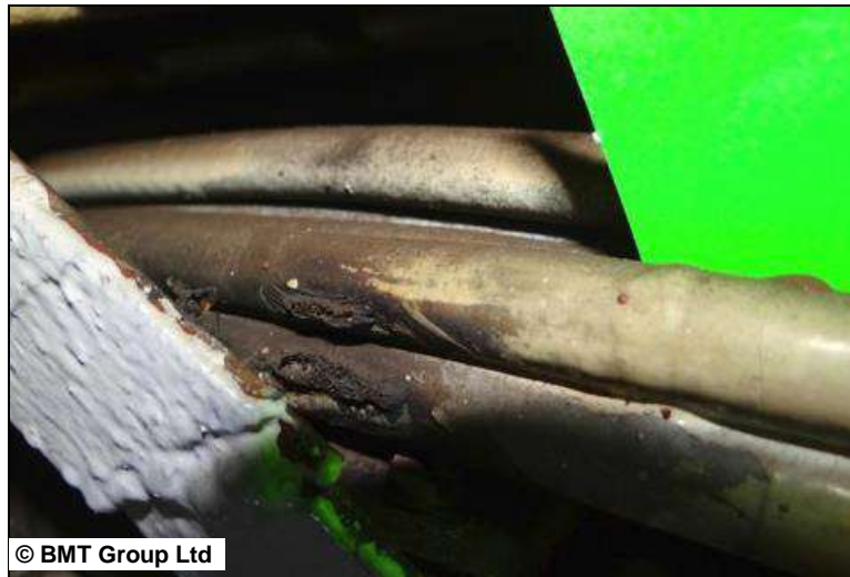
Abbildung 71: Beispiel für durch Schweißarbeiten beschädigte Kabelisolierung (1) 44
