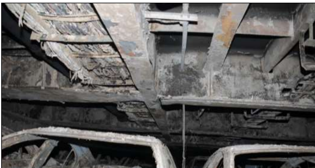
Abbildung 5: Auswirkungen des Feuers auf Laderaumdecke und Kabeltrassen
