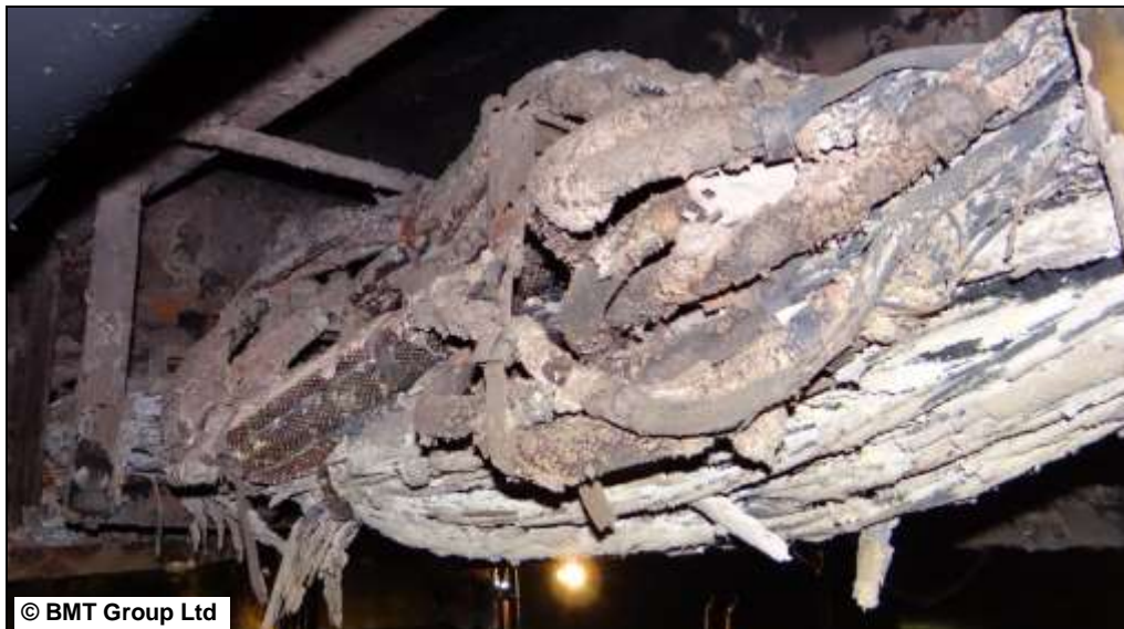
Abbildung 62: Kabelpleiße an der Decke des Fahrzeugdecks 3 B (Nahaufnahme) 35
