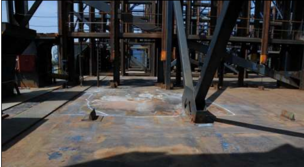
Abbildung 56: Decksaufrümpelungen und Brandschäden im Bereich Bay 26
