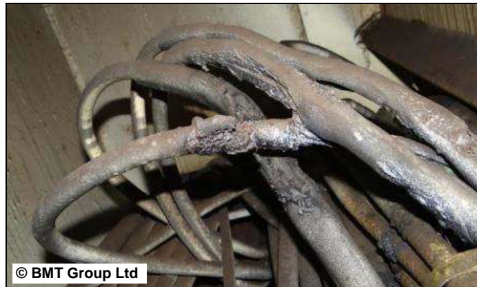
Abbildung 66: Beispiel für verschmorte Kabelisolierung (1) 39
