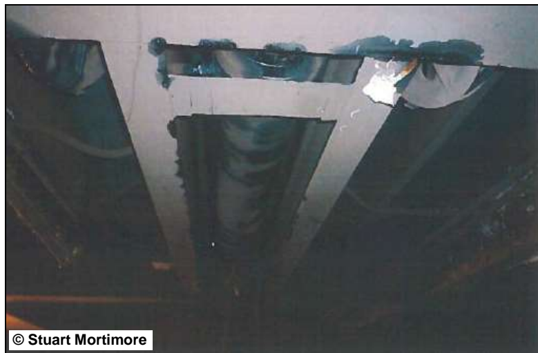
Abbildung 92: Beispiel für Hydraulikantrieb unter der Decke des Decks 3 B 65
