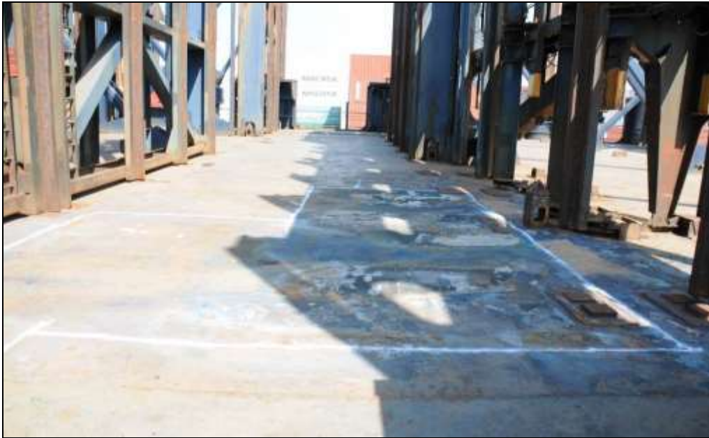
Abbildung 6: Hitzebedingte Verfärbungen und Deformierung auf dem Boden des Hauptdecks
