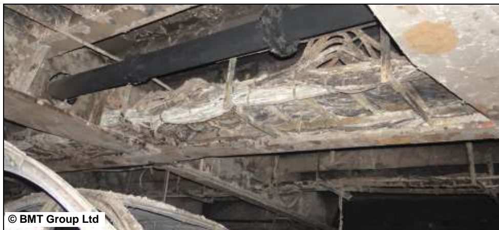
Abbildung 61: Kabelpleiße an der Decke des Fahrzeugdecks 3 B 34
