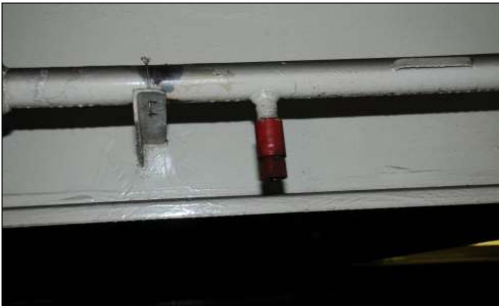
Abbildung 17: CO2-System-Rohrleitung mit Gasaustrittsdüse im Laderaum
