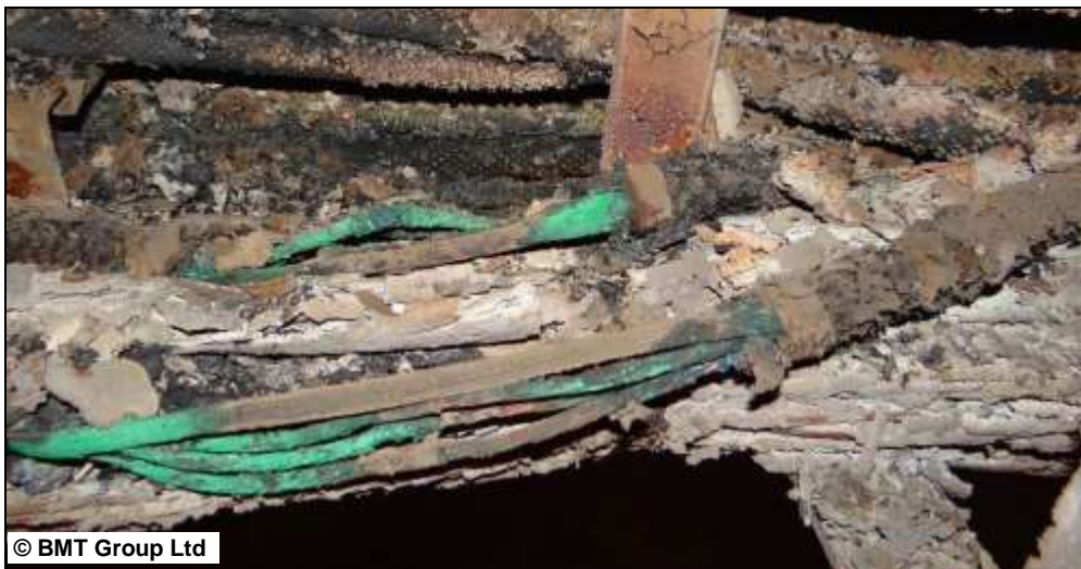
Abbildung 74: Beispiel für auffällige Korrosionsspuren in der Verkabelung 47
