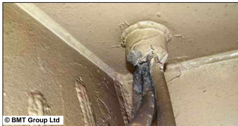
Abbildung 68: Beispiel für verschmorte Kabelisolierung (3) 41
