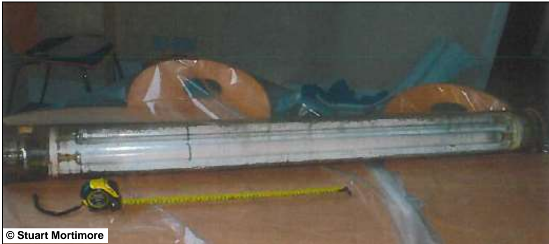
Abbildung 86: Muster der im Brandbereich installierten Deckenleuchte 58
