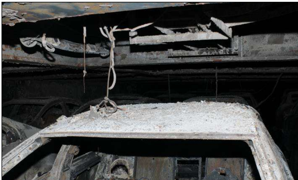
Abbildung 110: Nicht komplett verbrannte Kabelisolierung über PKW (hier: Abschirmung durch das Dach von PKW 4 C)
