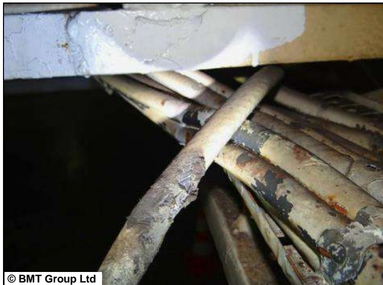
Abbildung 72: Beispiel für durch Schweißarbeiten beschädigte Kabelisolierung (2) 45
