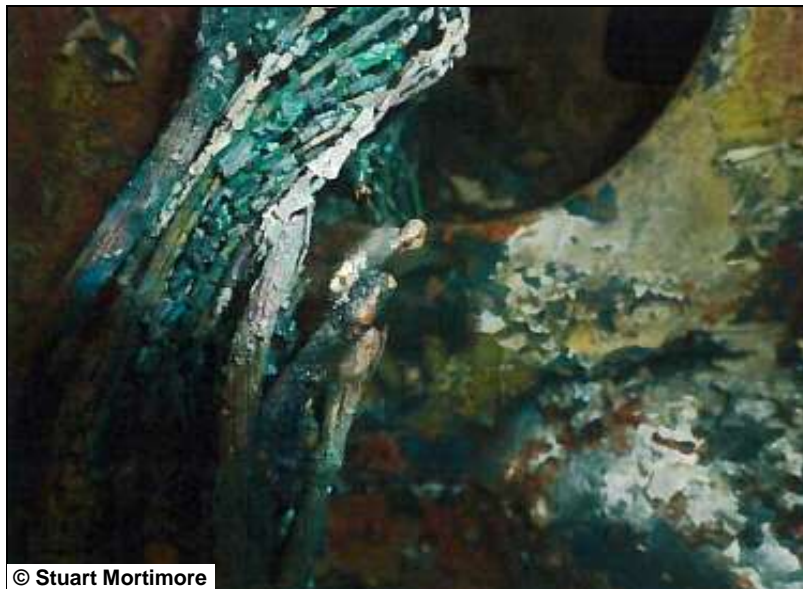
Abbildung 102: Beispiel einer durch elektrischen Strom verursachten Lichtbogenaktivität (1) 75
