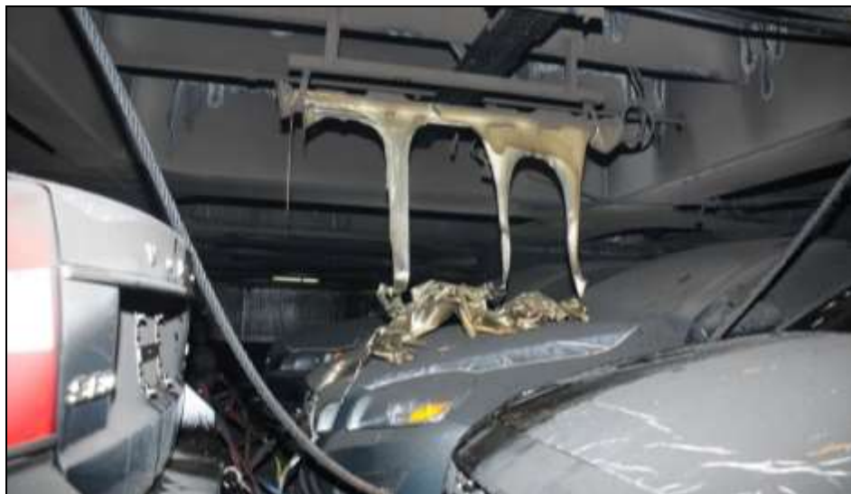
Abbildung 52: Durch Wärmestrahlung geschmolzene Kunststoffverkleidung einer Deckenleuchte
