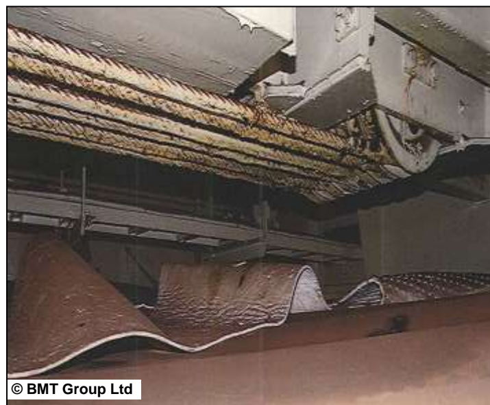
Abbildung 76: Detailaufnahme Schutzplane nebst Auflage zur Flüssigkeitsaufnahme
