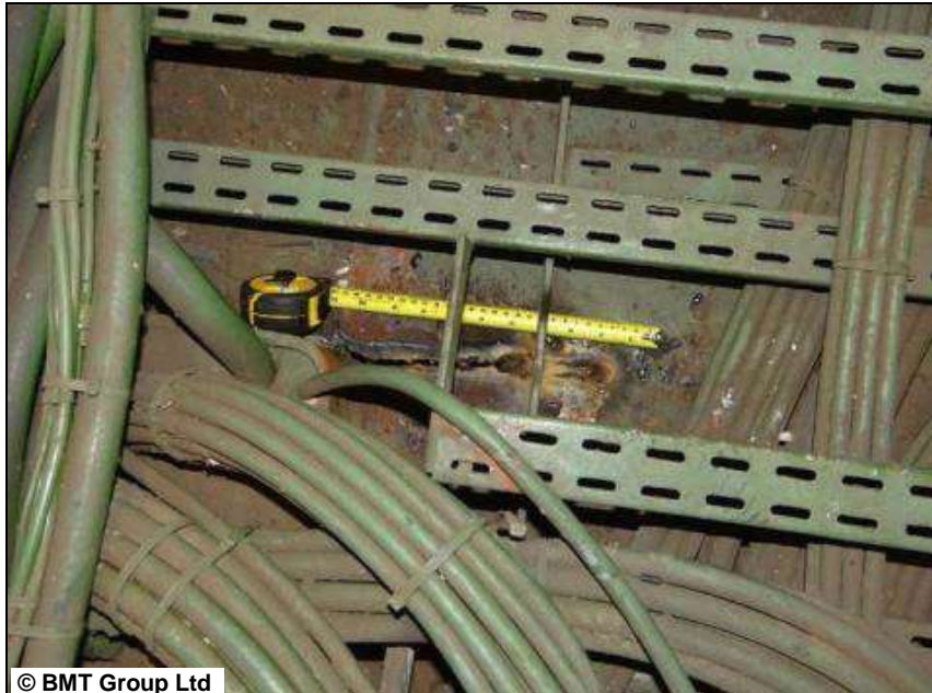
Abbildung 73: Beispiel für unmittelbare Nähe zwischen Schweißpunkt und Verkabelung 46
