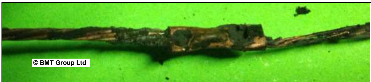
Abbildung 65: Kabelspleiß mit Unterschieden bzgl. Durchmesser und Anzahl der Stromleiter 38
