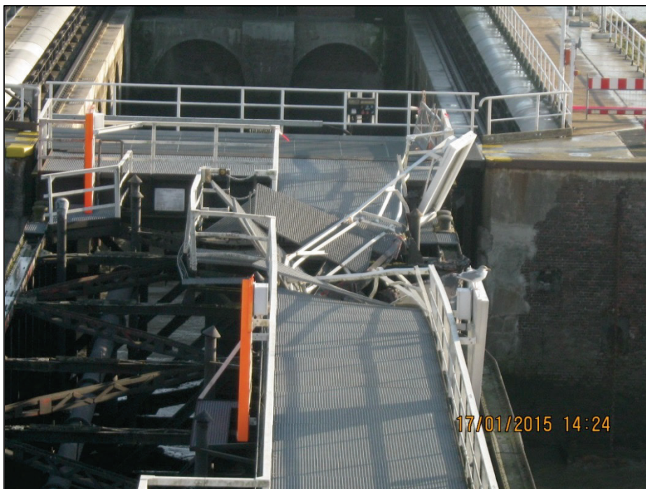
Abbildung 21: Schaden am Schleusentorweg
