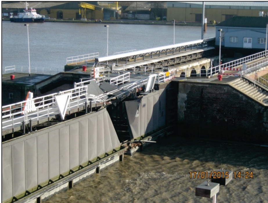
Abbildung 20: Schaden am Schleusentor
