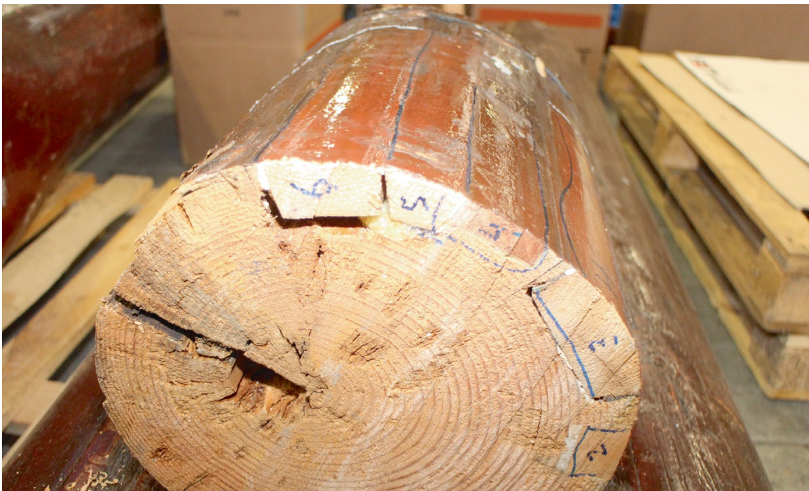
Abbildung 13: Querschnitt im Mastbereich hinter der Mastmanschette mit Reparaturleisten. Quelle: Untersuchungsrat für Sicherheit
