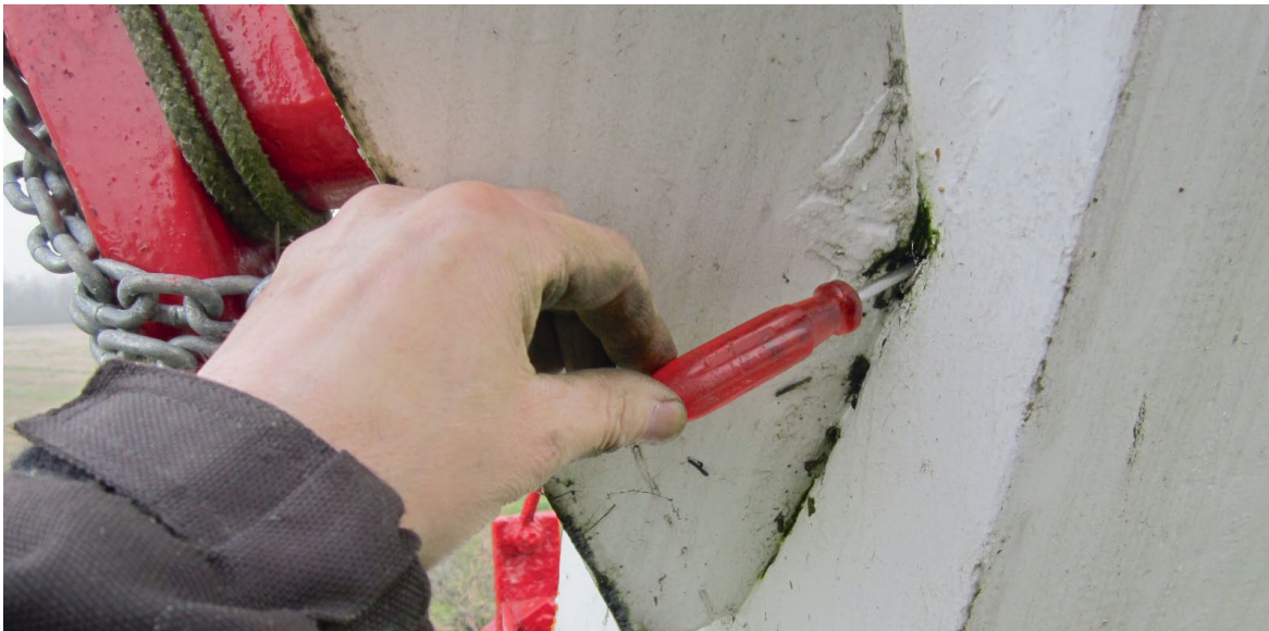
Abbildung 34: Schädigung im Bereich einer Verbindung zwischen zwei Balken. Foto: Van Reeuwijk Baumeister
