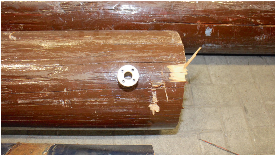
Abbildung 36: Außenseite des Masts. Foto: Untersuchungsrat für Sicherheit
