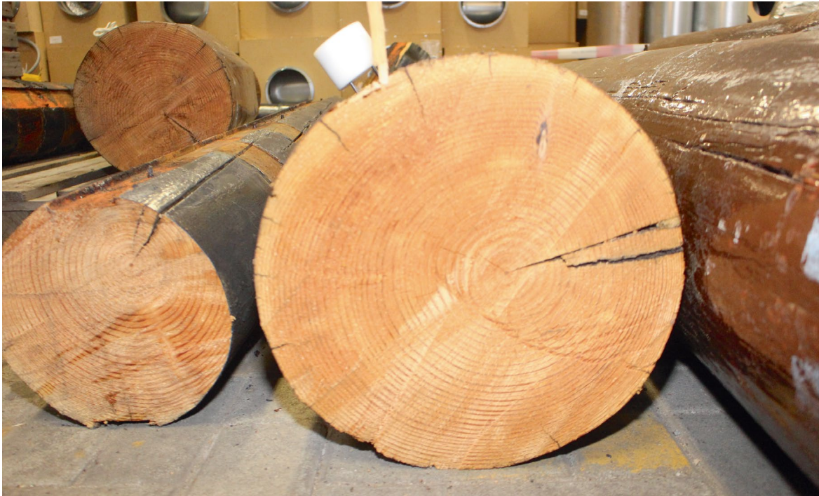
FAbbildung 47: Gut sichtbar ist, dass der große Windriss rechts bis zur Mitte des Masts reicht. Foto: Untersuchungsrat für Sicherheit
