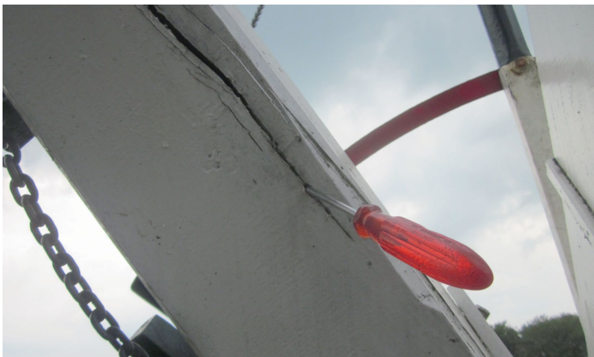
Abbildung 33: Schädigung im Bereich eines Windrisses. Foto: Van Reeuwijk Baumeister
