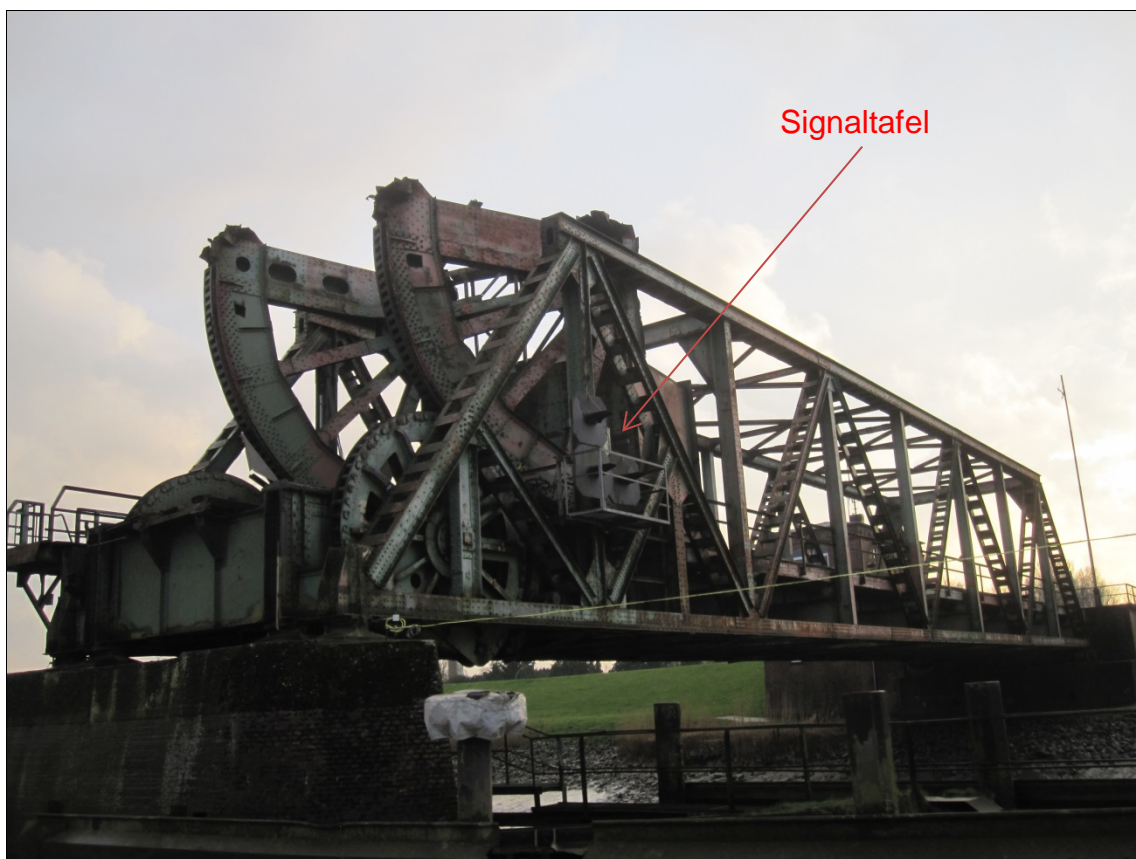
Abbildung 18: N-liche Durchfahrt mit zerstörter Brückenklappe und Signaltafel
