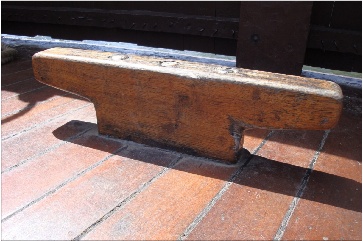
Abbildung 9: Beispiel einer intakten Holzklampe
