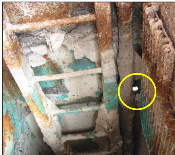
Abbildung 33: Durchrostung im Schacht der Raumleiter Backbordseite, hier Schott von Laderaum 3 zu Laderaum 2
