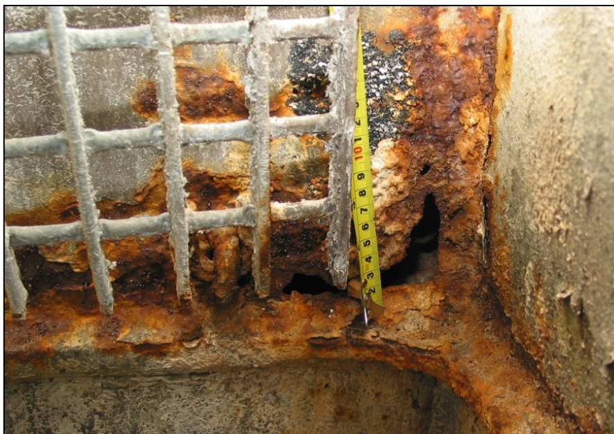
Abbildung 56: Durchrostung im Bereich einer Raumleiter
