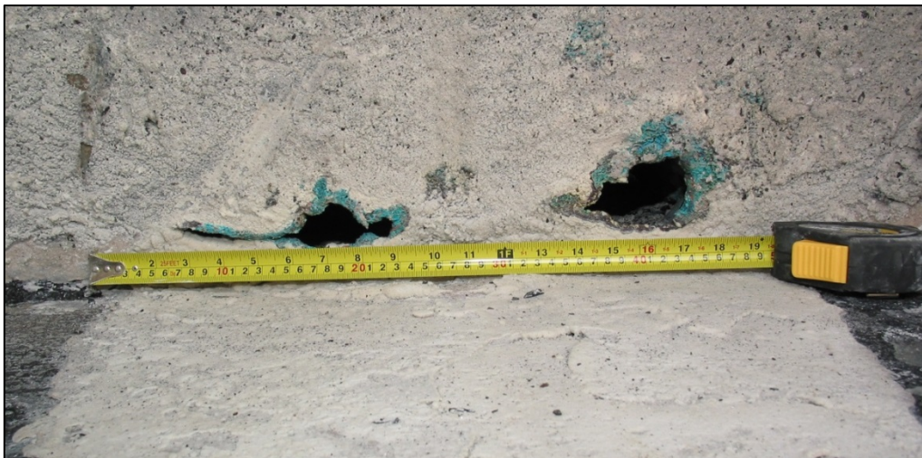
Abbildung 31: Durchrostung im unteren Bereich des Schotts von Laderaum 3 zu Laderaum 2
