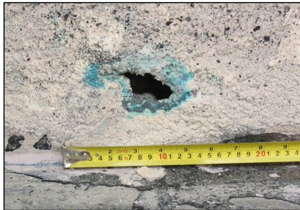
Abbildung 32: Weitere Durchrostung im unteren Bereich des Schotts
