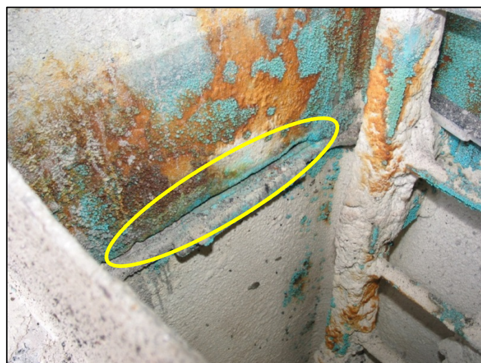
Abbildung 34: Weitere Durchrostung im Schacht der Raumleiter Laderaum 3, Vorkante des Zwischendecks, Backbordseite: Blick nach links vom Einstieg aus in Richtung des Zwischenraums B (siehe Abbildung 35).
