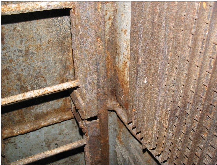
Abbildung 55: Durchrostung im Bereich einer Raumleiter
