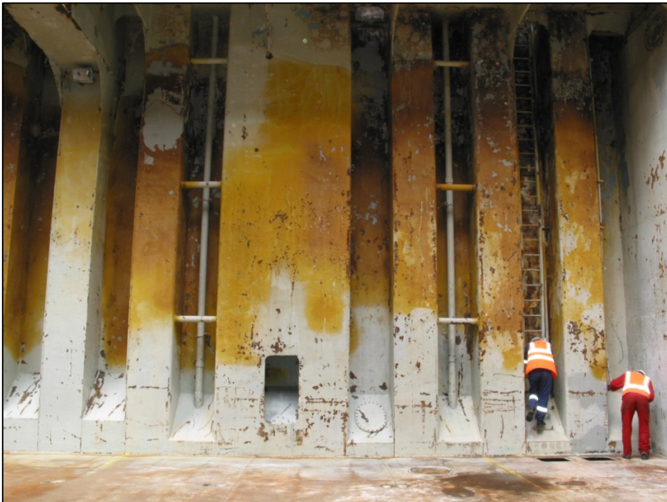
Abbildung 61: Unterraum Laderaum 2, Backbordseite der Achterkante mit Verfärbungen
