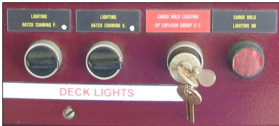
Abbildung 25: Zentraler Schalter für die Laderaumbeleuchtung auf der Brücke
