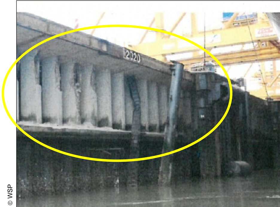
Abbildung 24: Schäden an der Pier
