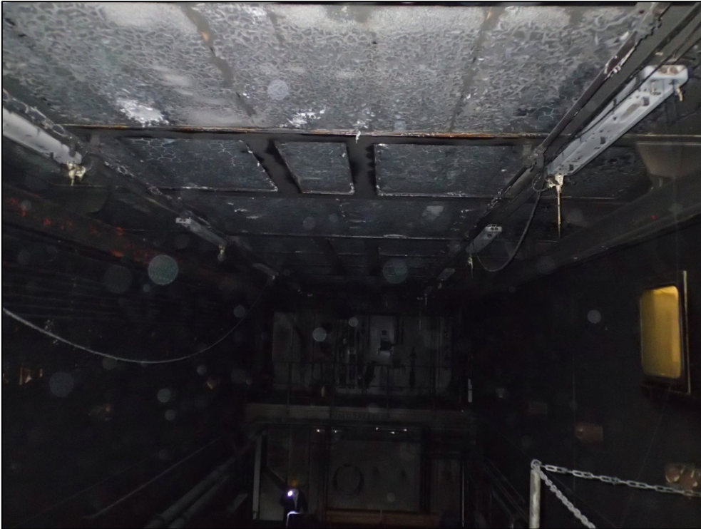
Abbildung 7: Brandspuren im Maschinenraum
