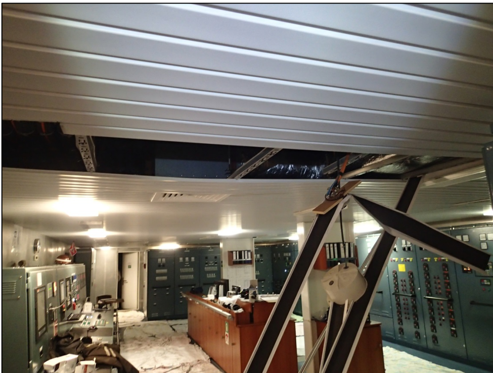
Abbildung 8: Maschinenkontrollraum mit gelöster Deckenverkleidung
