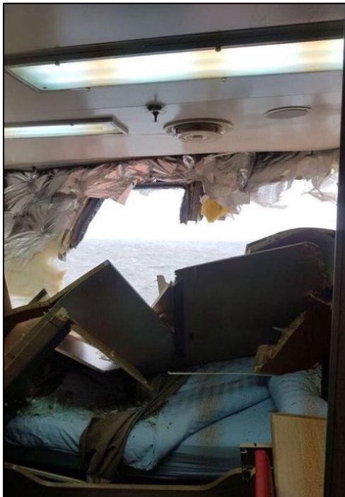
Abbildung 13: Schäden an der Außenwand einer Kammer
